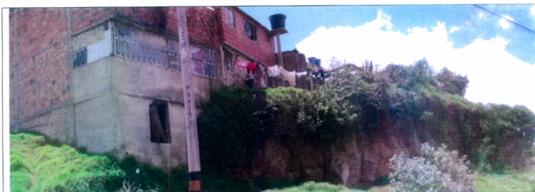
Fotografía No. 3. Aspecto del talud localizado en el costado norte de la manzana 11, en donde se observa la presencia de agua subsuperficiales proveniente de talud y la carencia de medidas de protección en el mismo.
