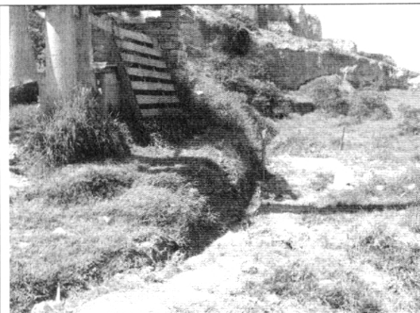
Fotografía No. 7 Manejo deficiente de agua de escorrentía en la zona adyacente a la manzana 23.
