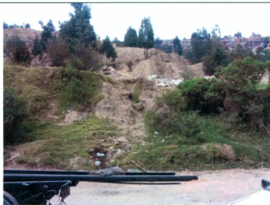
Fotografía No. 3 Rellenos antrópicos producto de la actividad minera, que carecen de medidas de contención, protección y drenaje, localizados al oriente del desarrollo Santa Cecilia I Sector.
