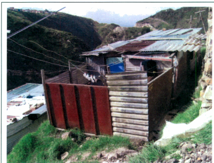
Fotografía No. 10. Tipología predominante de las viviendas en el desarrollo San José de los Sauces, que se caracteriza por viviendas en mampostería sin confinamiento estructural y la utilización en su construcción de materiales de recuperación.
