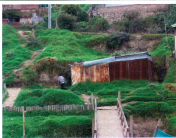
Fotografía No. 2. Taludes de corte para la implantación de las viviendas en la parte oriental del desarrollo SAN JOSÉ DE LOS SAUCES y que por sus características presenta una alta susceptibilidad al desarrollo de procesos de remoción en masa.
