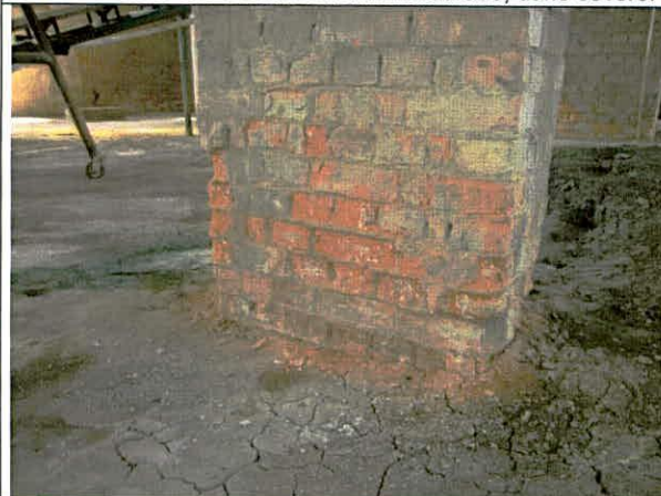
Foto 27. Deterioro de la mampostería de machones.
