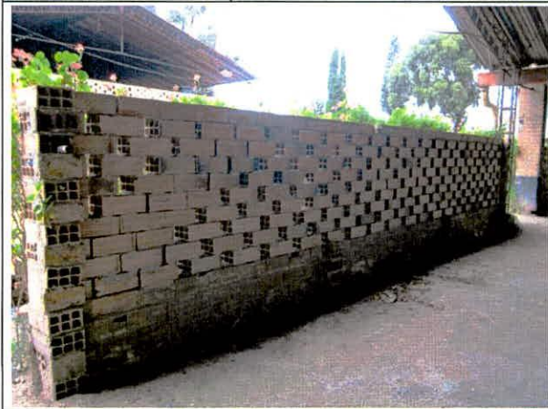
Foto 9. Muro extremo sur con deterioro y fisuras.
