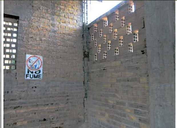
Foto 20. Muros perimetrales extremo sur con grietas.
