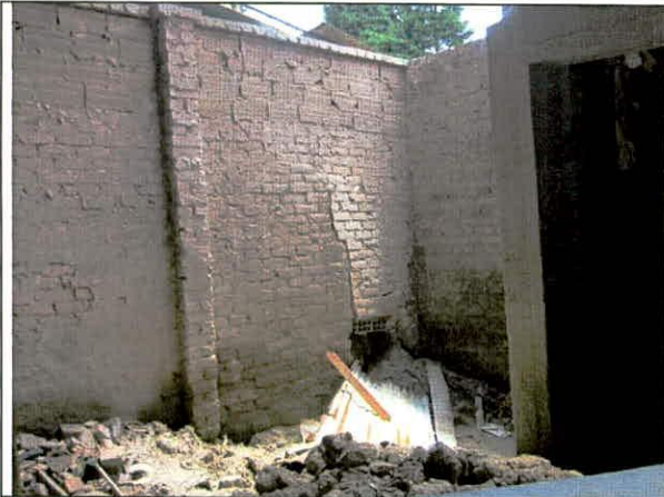
Foto 25. Muro del costado oriental fracturado, daño severo.
