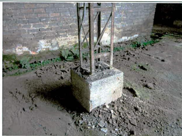
Foto 3. Corrosión y deterioro incipiente.
