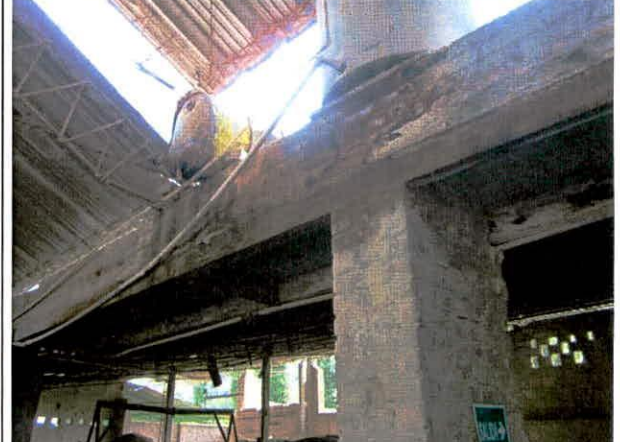
Foto 22. Deterioro de la mampostería de la canal.
