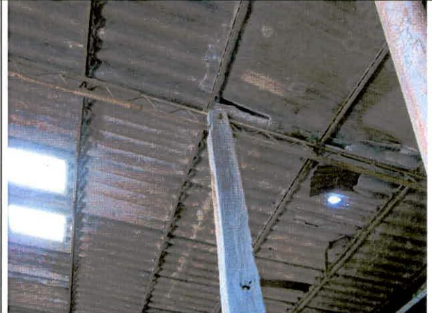
Foto 32. Rotura y deterioro de tejas.
