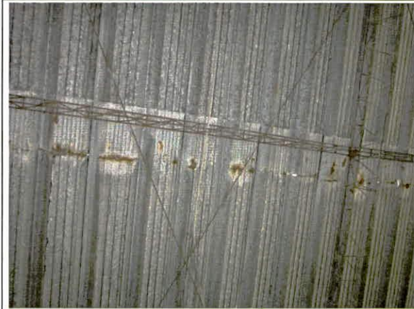
Foto 7. Corrosión incipiente de las canaletas metálicas.
