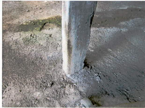
Foto 33. Deterioro de postes de madera.
