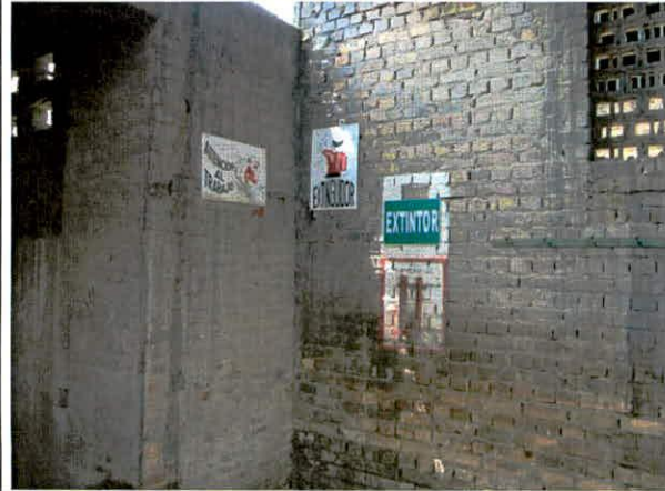
Foto 21. Deterioro de la mampostería, muros perimetrales.
