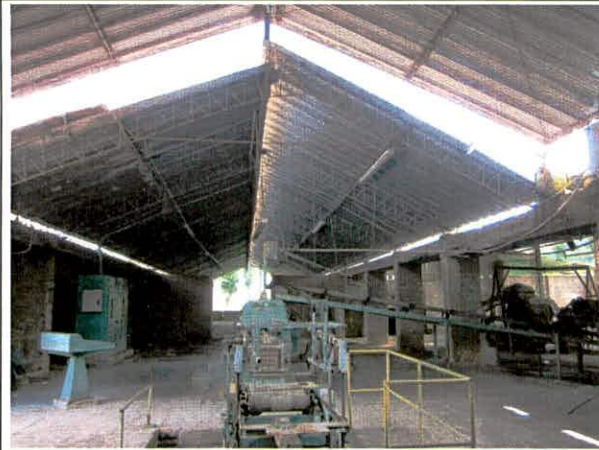
Foto 19. Zona de la extrusora costado occidental.
