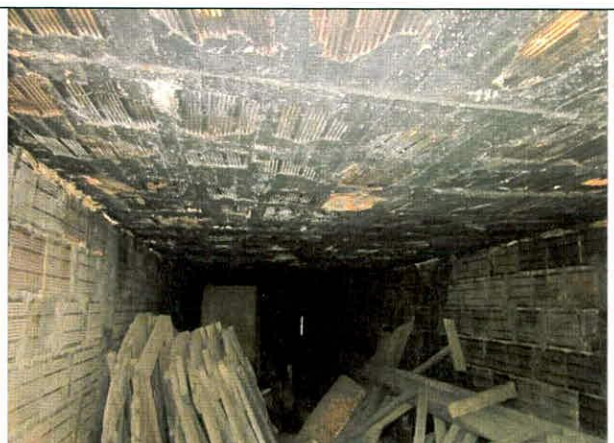
Foto 4. Deterioro y fisuras en la cara inferior de la placa.
