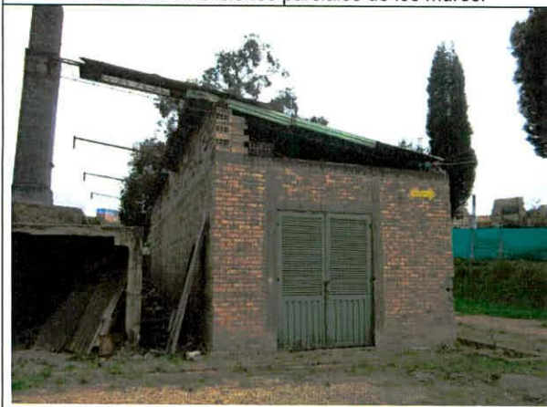
Foto 13. Muros en ladrillo tolete sin acabados.
