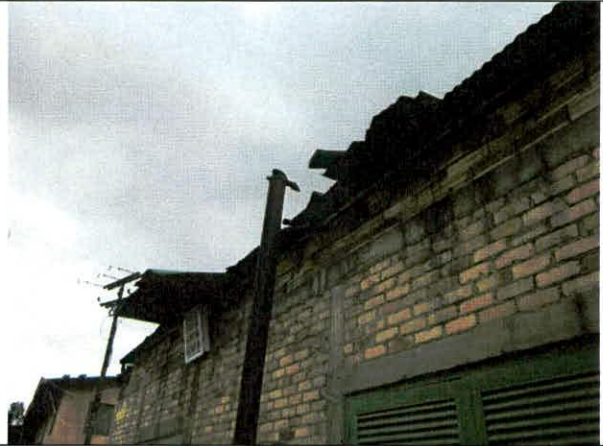
Foto 18. Deterioro de las tejas.
