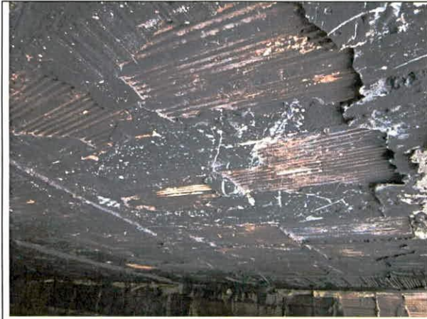
Foto 5. Daños y deterioro de la placa de cubierta.
