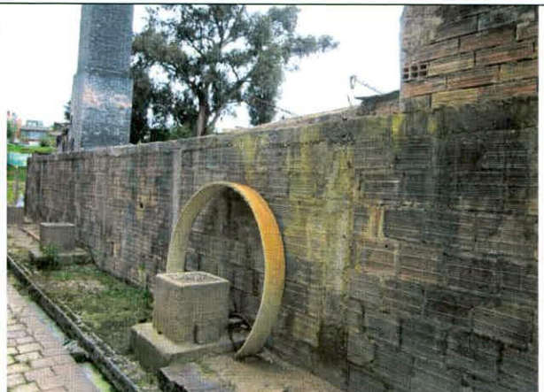
Foto 2. Deterioro de los muros, sin acabados.
