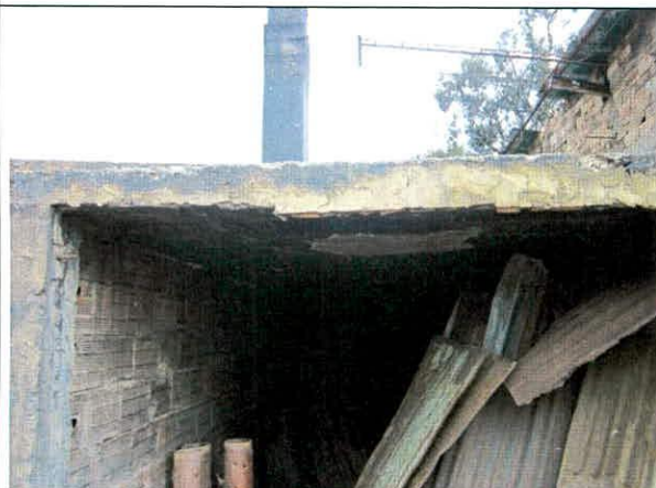
Foto 3. Deflexiones en la placa de cubierta.
