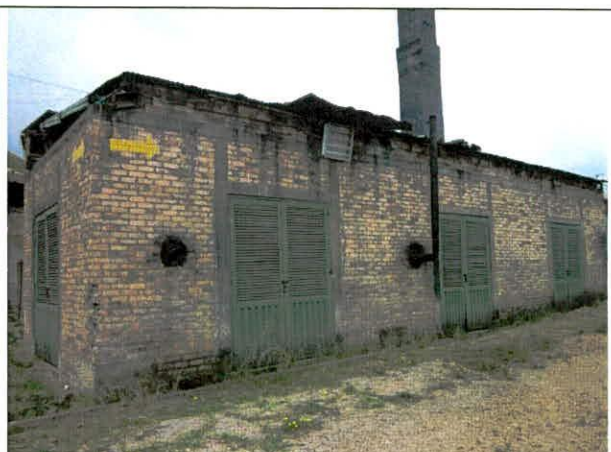
Foto 12. Cuarto de Planta Eléctrica.
