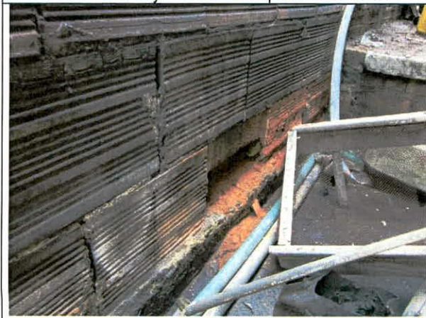
Foto 7. Deterioro de los bloques de arcilla.
