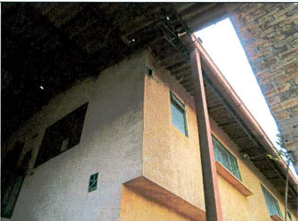
Foto 22. Deterioro leve de los acabados por humedad.
