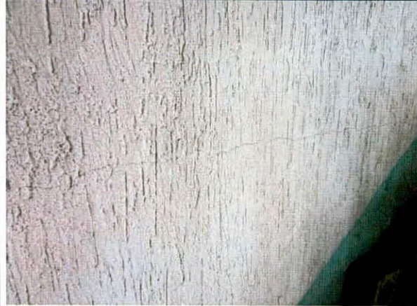
Foto 25. Fisura en muro por junta con placa.
