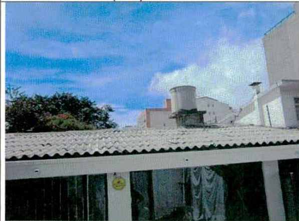
Foto 17. Cubierta en fibro cemento, daño leve.
