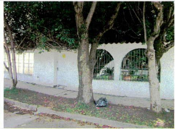
Foto 2. Cerramiento sin daño visible, hundimiento del andén.
