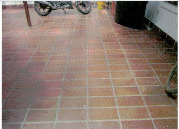
Foto 18. Buen estado de la placa de piso y sus acabados.
