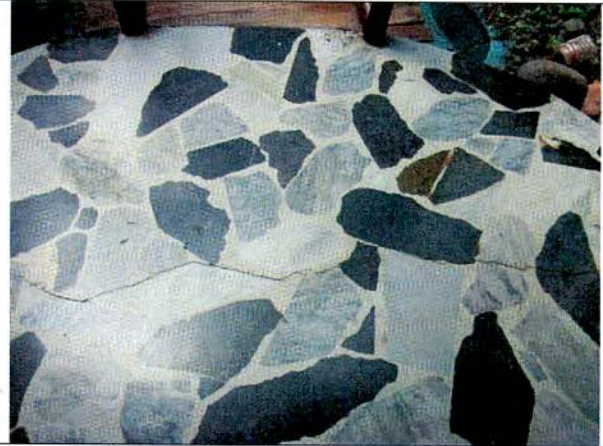
Foto 20. Fisura por junta entre elementos de la placa.
