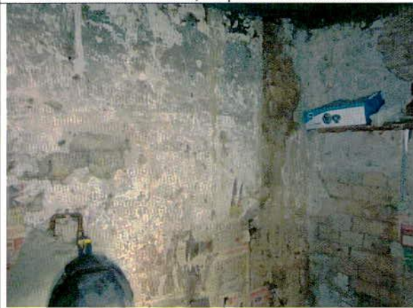
Foto 15. Fisuras y deterioro de acabados de muros.
