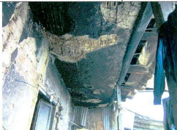
Foto 26. Deformación y deterioro fuerte del cielo raso.
