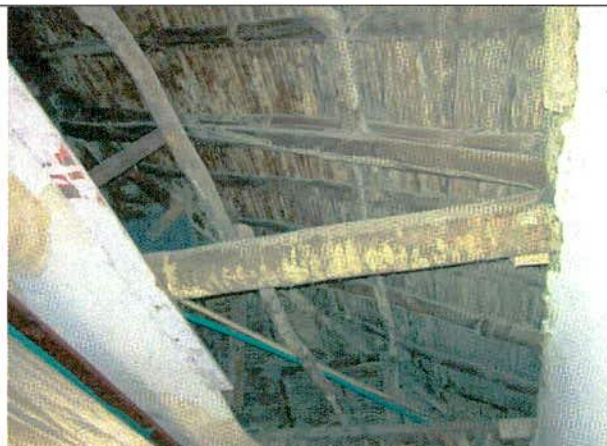
Foto 24. Deterioro de los elementos de soporte de la cubierta.
