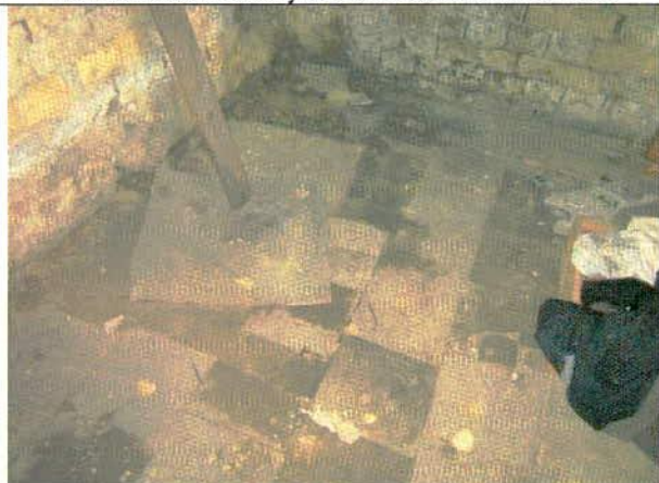
Foto 28. Deterioro generalizado del piso.
