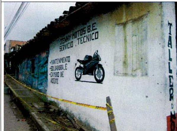
Foto 3. Deterioro de acabados del muro de fachada.
