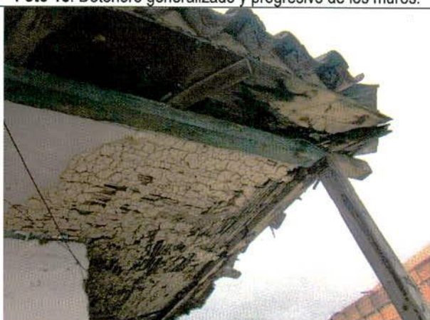
Foto 20. Deterioro de los elementos de madera del alero.
