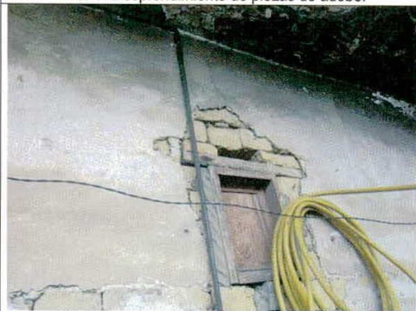
Foto 9. Deterioro y desprendimiento del pañete.
