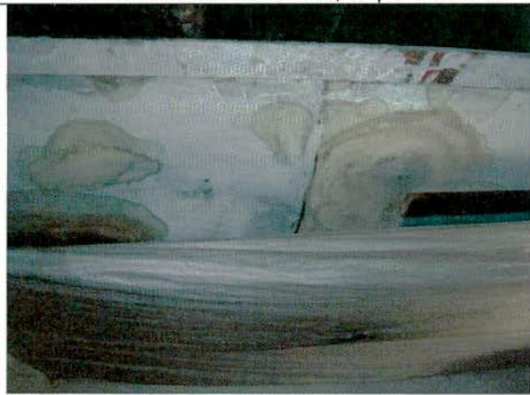
Foto 27. Reemplazo del cielo raso, humedad y deterioro.
