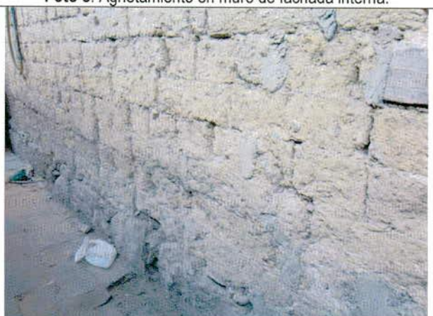
Foto 10. Deterioro de los adobes, sin recubrimiento.
