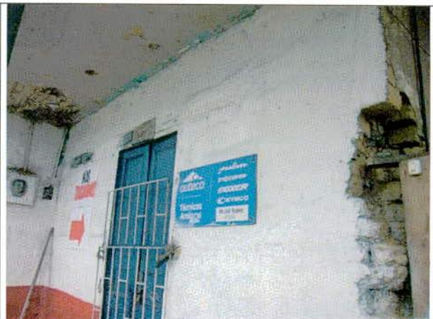
Foto 6. Fachada sobre la Calle 137 Sur, deterioro.
