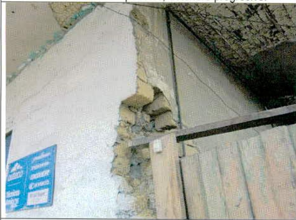
Foto 7. Desprendimiento de piezas de adobe.
