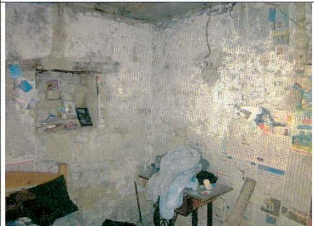
Foto 16. Deterioro fuerte de los muros internos.
