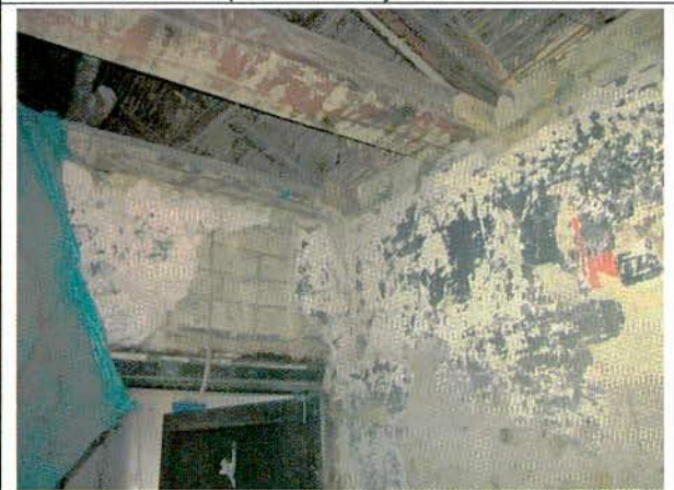
Foto 14. Daño fuerte de los muros internos.
