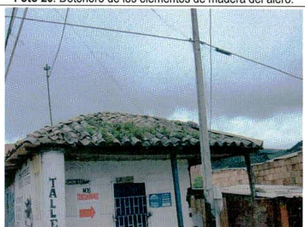
Foto 22. Cubierta en teja de barro, crecimiento de vegetación.
