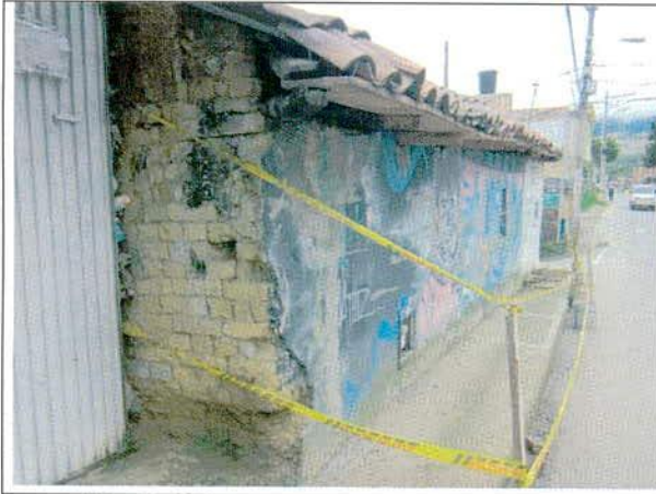
Foto 5. Adobes expuestos, deterioro progresivo.
