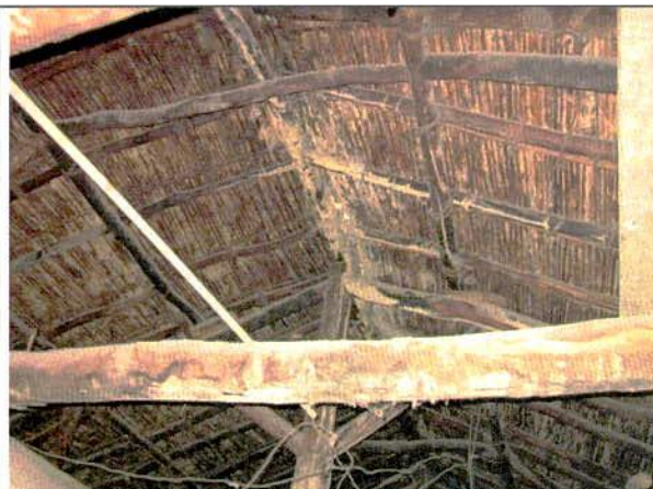
Foto 23. Daños de la cubierta y fallas funcionales.
