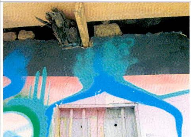
Foto 4. Agrietamientos en dintel de fachada.
