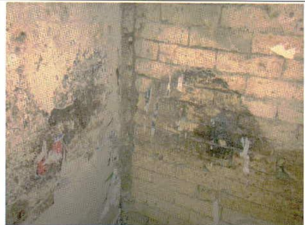
Foto 18. Deterioro generalizado y progresivo de los muros.
