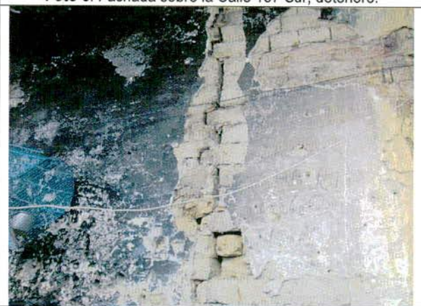
Foto 8. Agrietamiento en muro de fachada interna.
