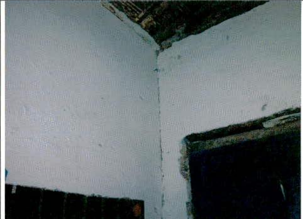
Foto 12. Separación de la junta entre muros.
