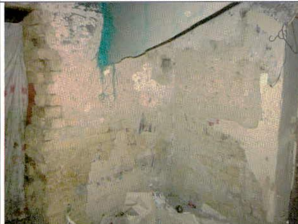
Foto 13. Daño de muros, desprendimiento de adobes.
