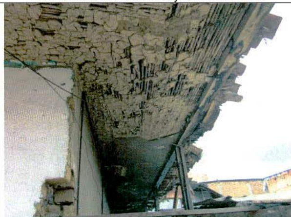
Foto 25. Daño fuerte del cielo raso, desprendimientos.
