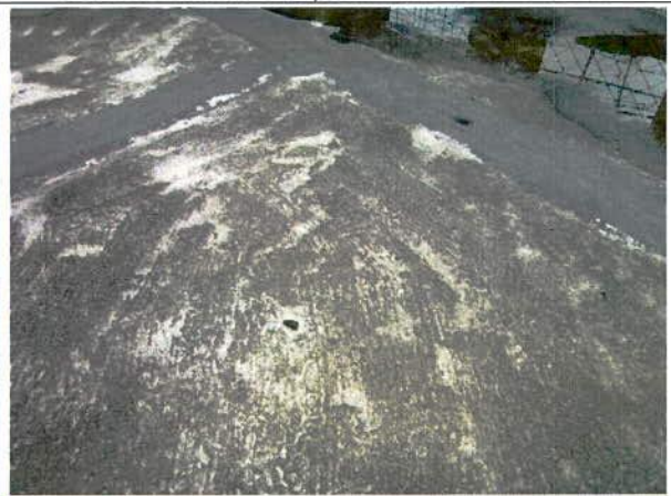
Foto 26. Placa de la azotea, algunas fisuras.
