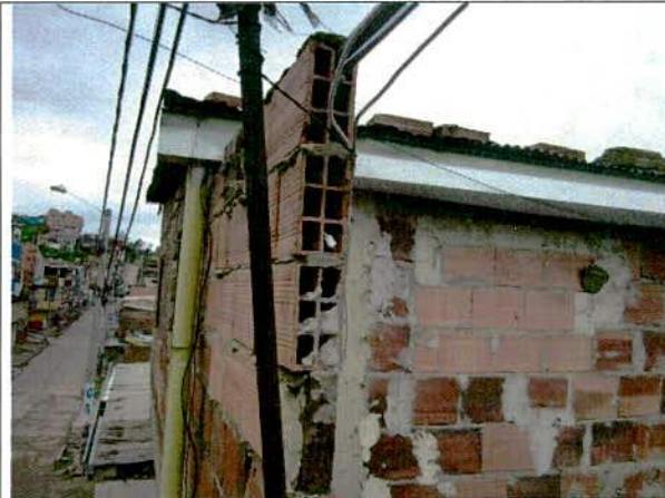
Foto 9. Leve pérdida de verticalidad de la fachada.
