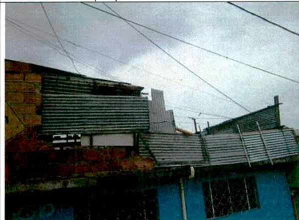
Foto 13. Colapso parcial y cerramiento provisional.
