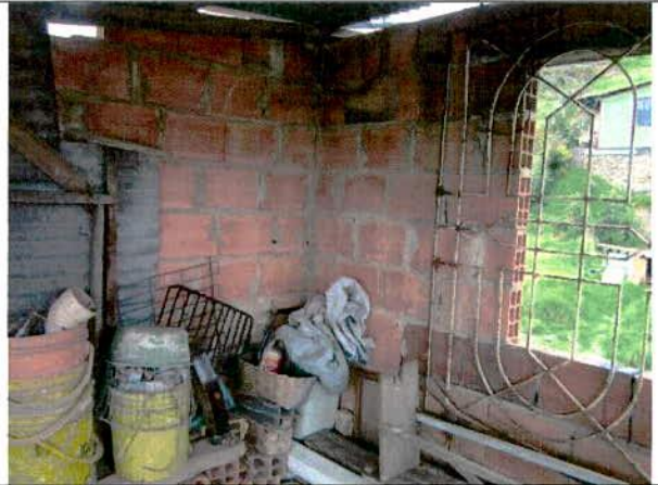
Foto 10. Fisuras en esquina suroriental, vista interna.
