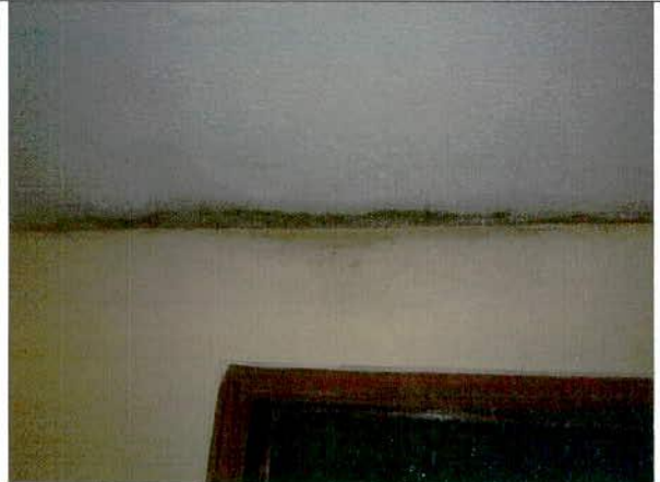
Foto 17. Deterioro incipiente de los acabados de muros.
