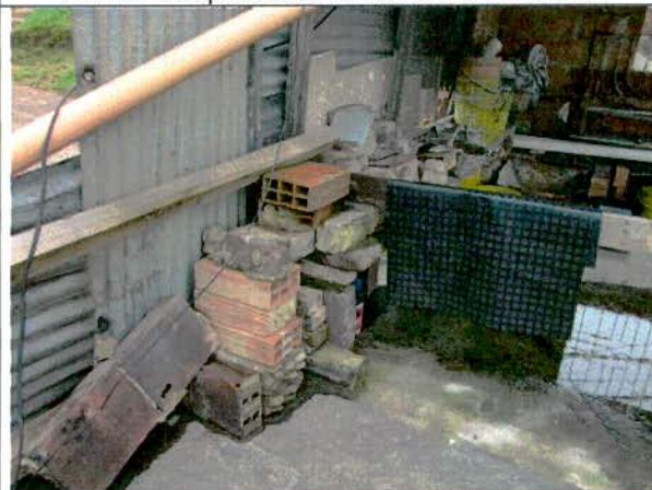
Foto 11. Colapso parcial tramo del costado oriental.
