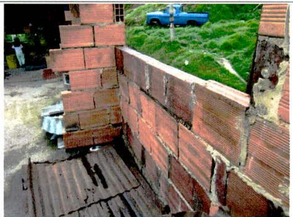
Foto 8. Fisuras en de fachada del costado sur segundo piso.
