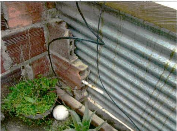
Foto 12. Bloques que quedaron luego del colapso parcial.
