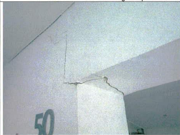
Foto 23. Grieta en dintel del segundo nivel.
