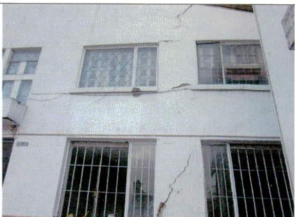
Foto 6. Daño severo del muro de fachada, extremo norte.
