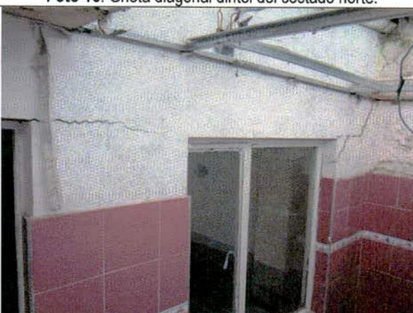
Foto 18. Daño fuerte de los muros internos del costado norte.
