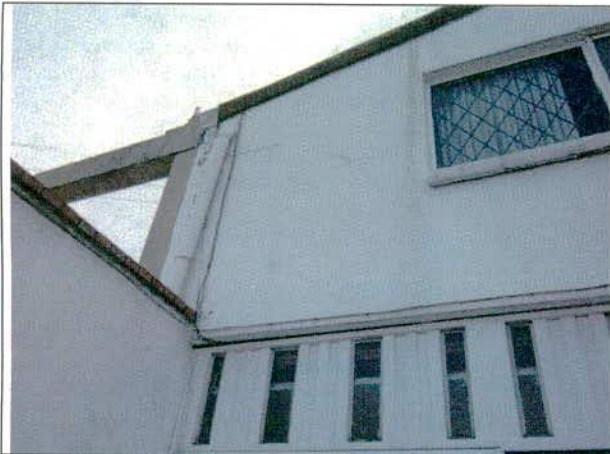
Foto 3. Grieta en el extremo sur del segundo piso.
