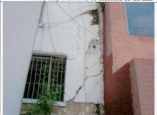
Foto 7. Fractura del muro en el extremo norte.
