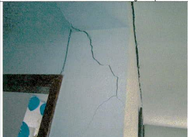
Foto 24. Daño en muros del costado norte, segundo piso.
