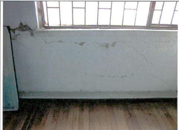
Foto 10. Grietas y fisuras de la fachada, cara interna.
