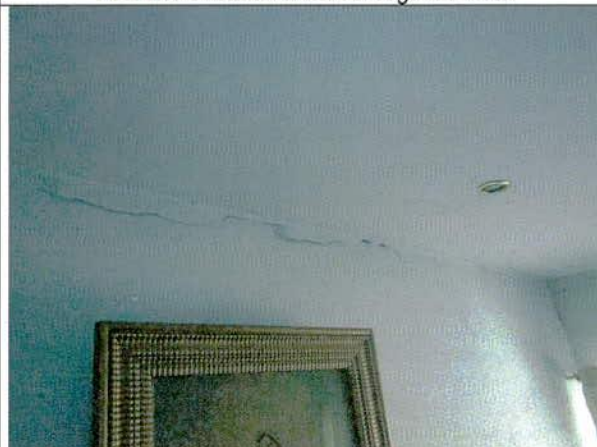
Foto 25. Grieta en la junta entre cielo raso y muro.
