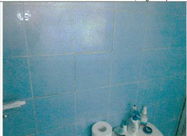
Foto 26. Grieta en muro del baño del segundo piso.
