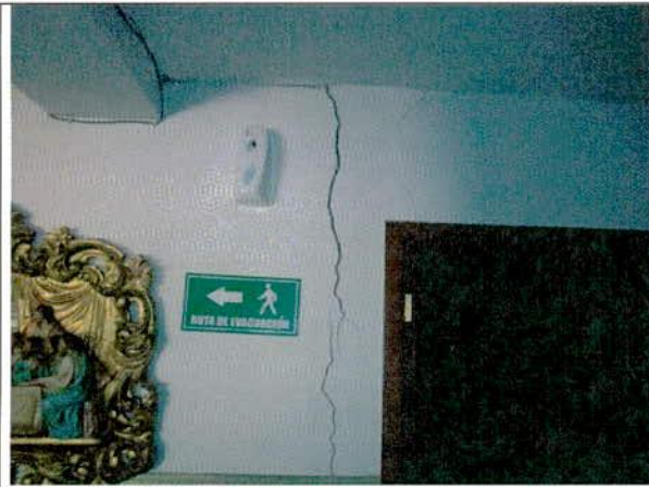
Foto 21. Daños en muros de segundo piso.
