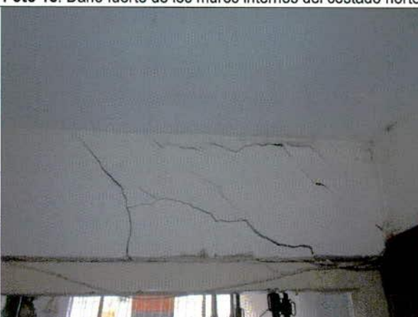
Foto 20. Grietas en dintel del costado norte, primer piso.
