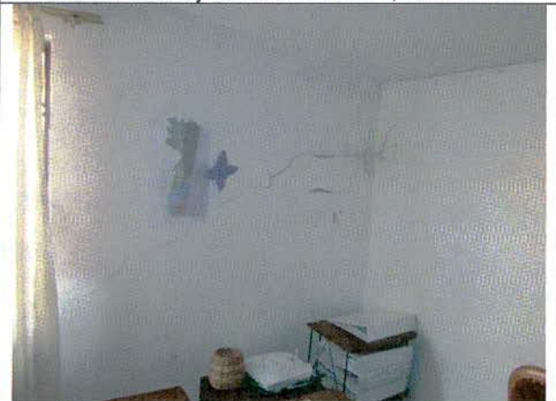
Foto 12. Grieta en el extremo sur de la fachada, vista interna.
