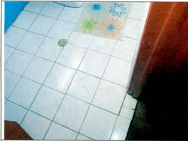
Foto 27. Grietas y daño en el entrepiso.
