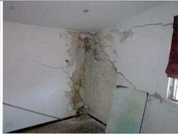
Foto 9. Fracturas del extremo norte del muro, vista interna.
