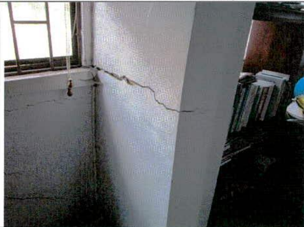
Foto 11. Grieta horizontal en muro adosado a la fachada.
