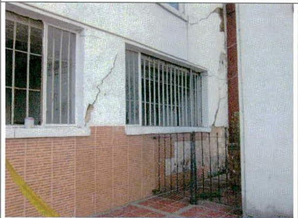
Foto 5. Grietas y desprendimiento de acabados de fachada.
