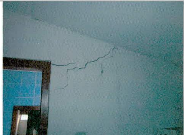
Foto 22. Grieta en muro interno de segundo piso.
