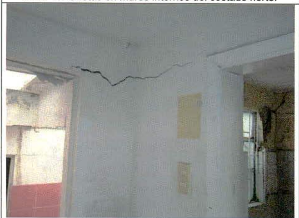
Foto 17. Grietas en muros de primer piso costado norte.
