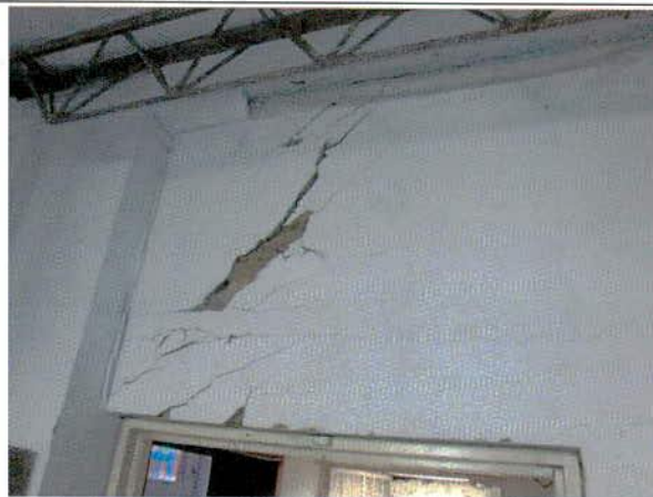
Foto 16. Grieta diagonal dintel del costado norte.
