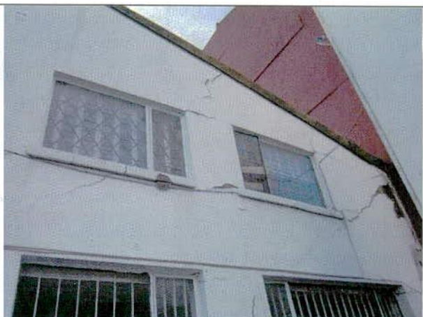
Foto 4. Agrietamientos en el muro de fachada, extremo norte.
