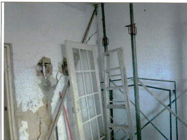
Foto 15. Grietas en muros internos del costado norte.
