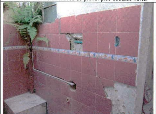
Foto 19. Fractura del muro de lindero del costado norte.
