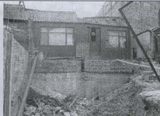
Fotografía 9. Se aprecia las técnicas constructivas deficientes y el manejo de cortes realizados, dentro del desarrollo.
