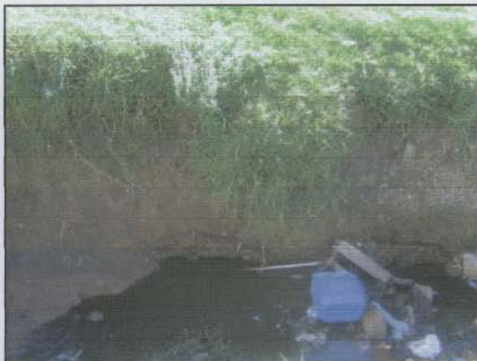
Fotografía 6. Detalle de la socavación del cauce en el relleno hacia la margen izquierda de la Quebrada Las Lajas.
