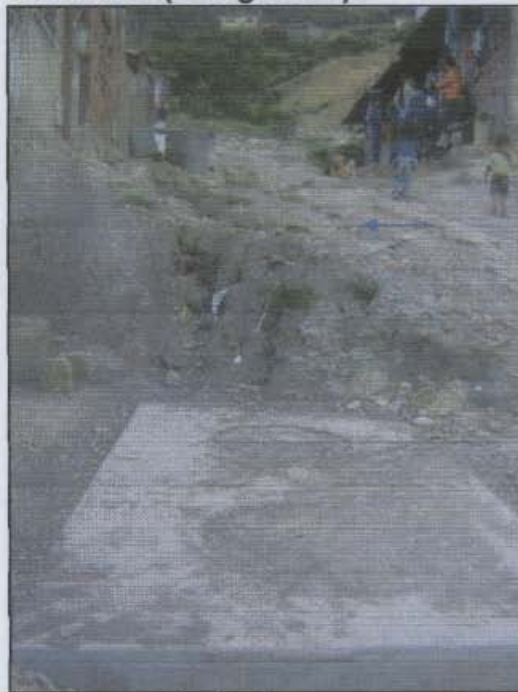
Fotografía 5. Detalle, de la erosión laminar y surcos en la calle central del barrio Ramírez.
