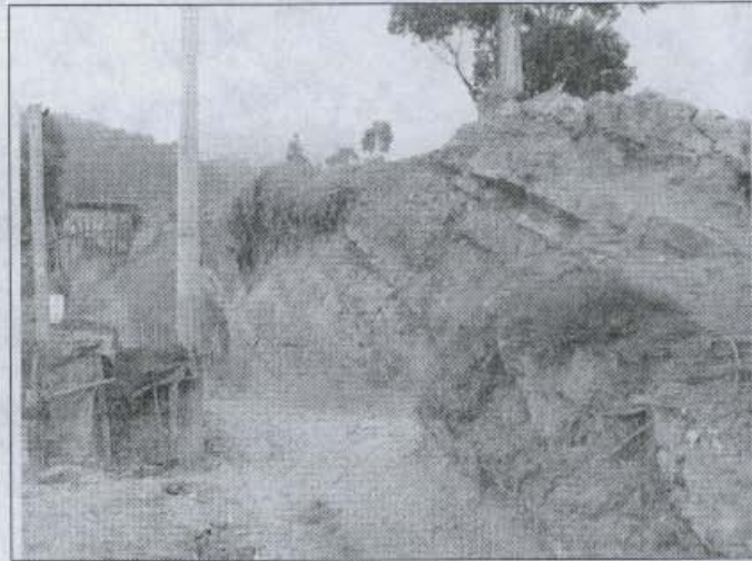
Fotografía 3. Escarpe en contrapendiente estructural, conformado por arcillolitas y limolitas de la Formación Bogota, en la parte alta del desarrollo Triángulo Alto.
