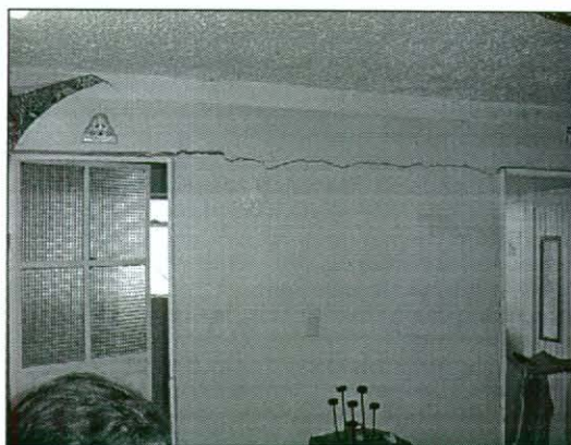
Fotografía 2. Interior de la vivienda 03 donde se presentan grietas de aproximadamente 1 cm de abertura.
