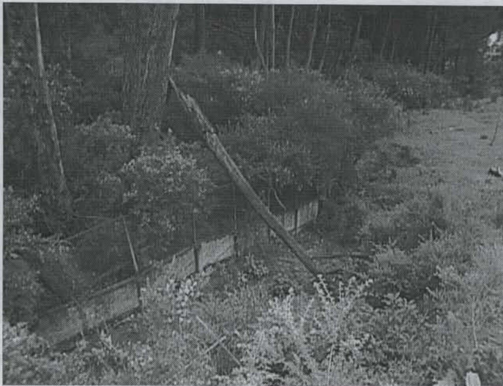
Fotografía No. 2. Detalle de la deformación de una cerca instalada en el extremo oriental del globo B y de la inclinación de los árboles, debido al empuje ejercido por el terreno.
