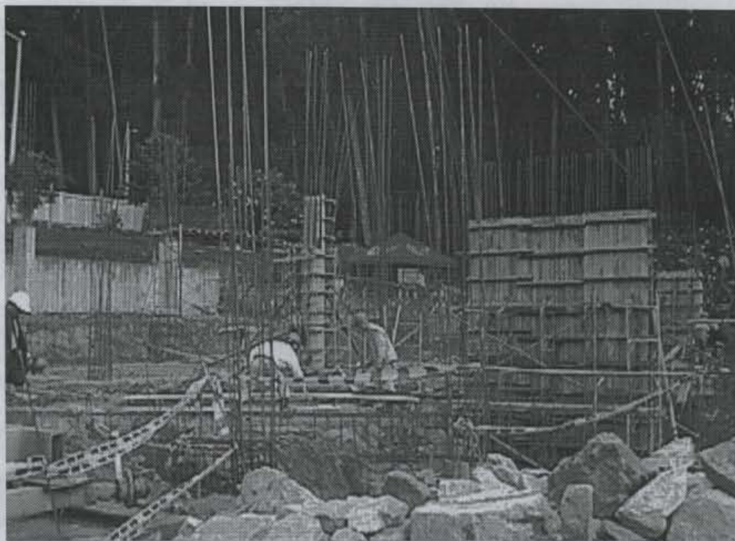
Fotografía No. 5. En el extremo izquierdo de la fotografía se observa un muro de contención construido para restituir el confinamiento de este sector de la ladera.
