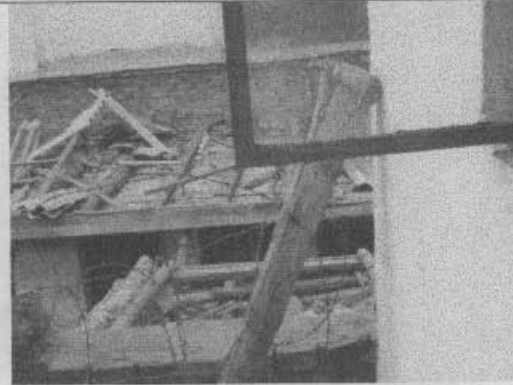
Foto 4. Elementos estructurales sueltos.
