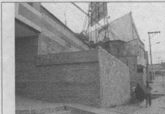
Foto 1. Fachada de la edificación totalmente sellada.
