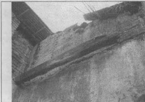
Foto 3. Elementos estructurales sueltos.
