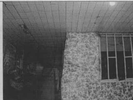
Foto 10. Deformación de marcos de puertas y ventanas.
