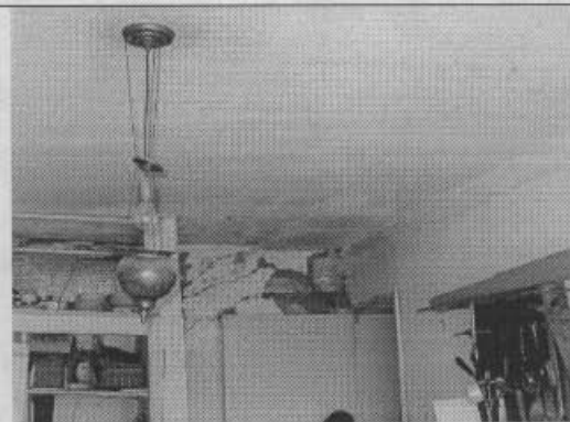
Foto 11. Agrietamiento severo en muros interiores.
