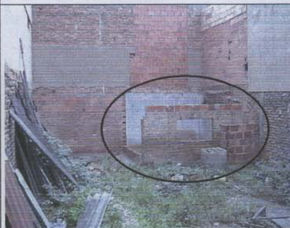
Foto 4. Los muros interiores están sueltos con desprendimiento de elementos y no existe cubierta.
