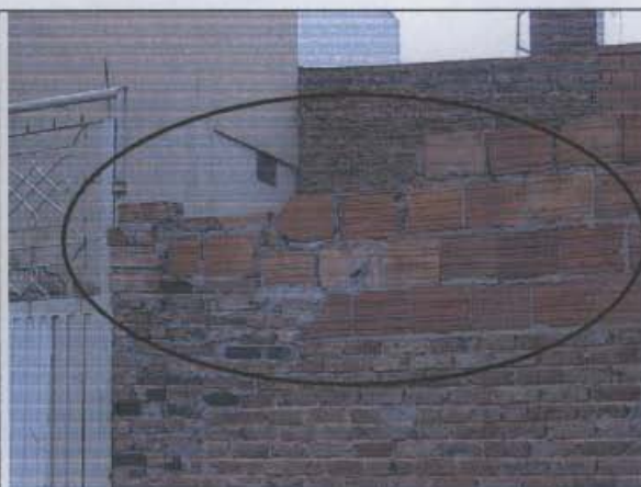
Foto 2. Muro de fachada suelto, sin ningún tipo de amarre estructural.
