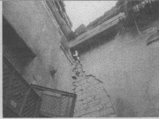
Foto 8. Colapso parcial de la cubierta.
