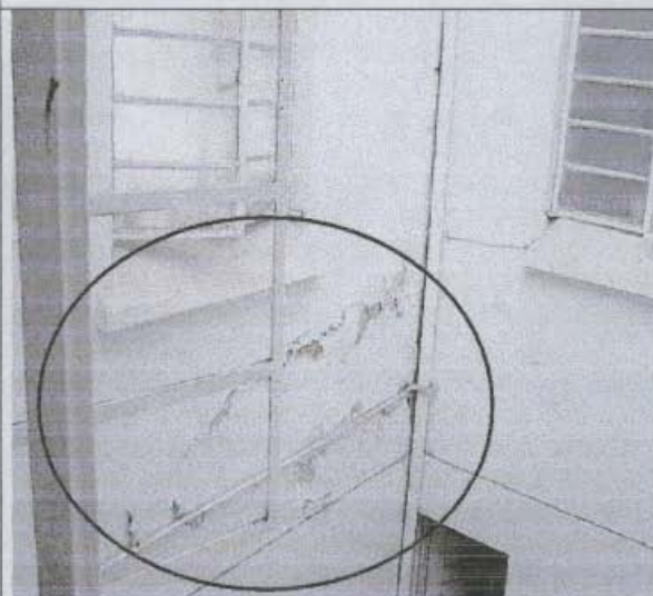
Foto 7. Vista interna de la zona de patio, se detectaron humedades y desprendimientos de acabados.
