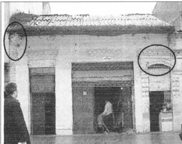
Foto 1. Condiciones de Fachada – Muros fisurados
