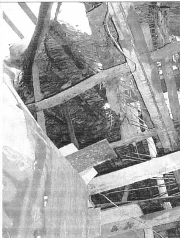
Foto 6. Desprendimiento de elementos en cubierta. Los muros están sueltos de la estructura.
