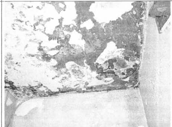
Foto 4. Deterioro progresivo de la edificación y techos con desprendimiento de acabados.
