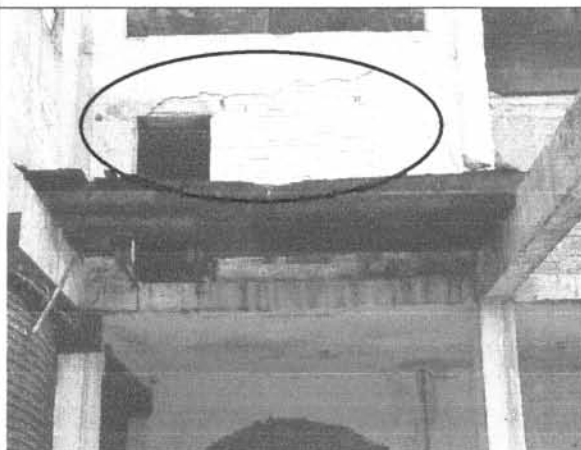
Foto 14. Muro de la bodega presenta agrietamientos que comprometen la estabilidad del mismo.
