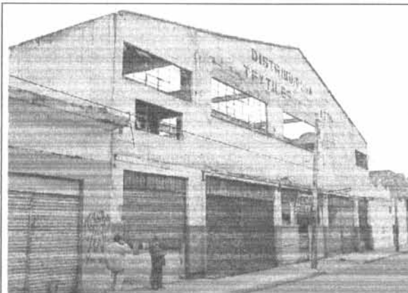
Foto 1. Condiciones de la Edificación – Rotura de vidrios y deterioro en la fachada.
