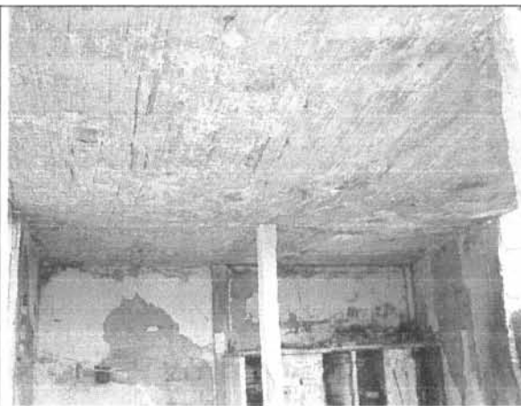
Foto 12. Deflexión excesiva en mezanines.
