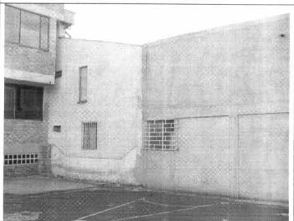
Foto 4. Fachada por el costado sur y junta con edificación vecina sin daño visible.
