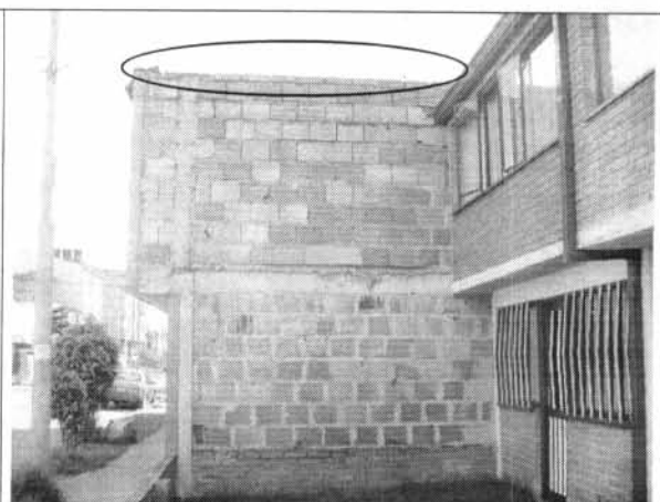
Foto 2. Muro costado norte, no presenta daño alguno, falta viga de coronación en segundo piso.
