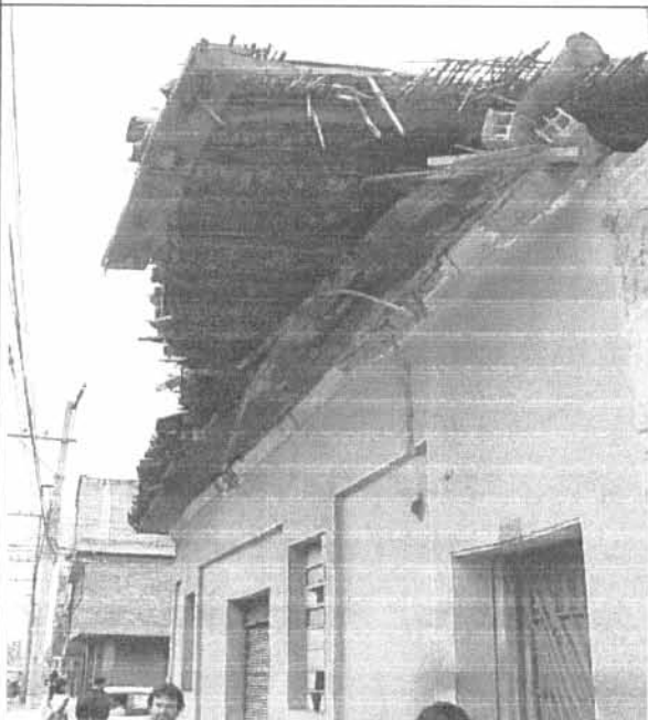
Foto 3. Muros fracturados y caída de elementos de cubierta.
