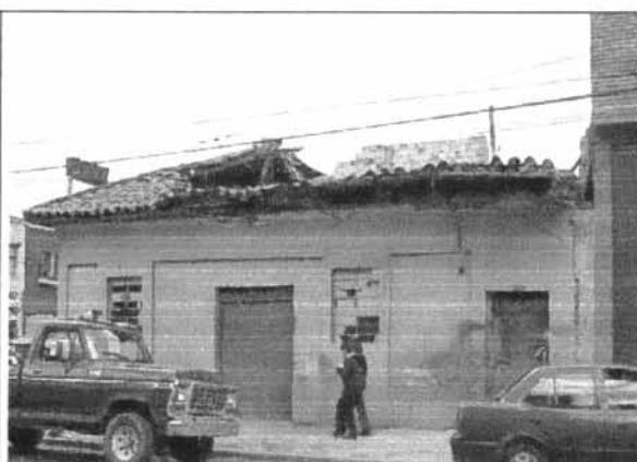
Foto 2. Deterioro de la edificación.
