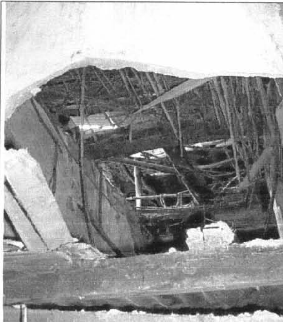
Foto 5. Entramado de cubierta destruido.
