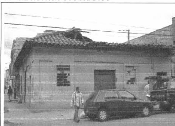
Foto 1. Condiciones de Fachada – desprendimiento de cubierta.
