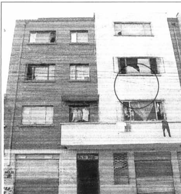
Foto 1. Condiciones de la Edificación – Rotura de vidrios en la fachada.
