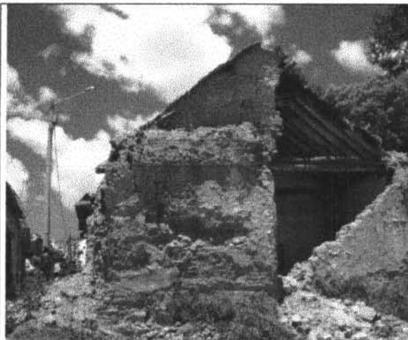
Foto 1. Fachada con colapso parcial
