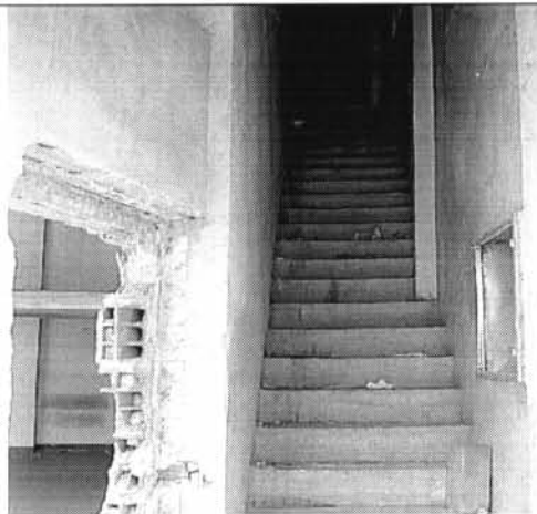
Foto 3. Deterioro progresivo de la edificación
