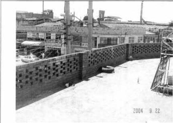
Foto 3. Aspecto interno del muro de antepecho perimetral de la terraza del inmueble, tramo en rejilla.
