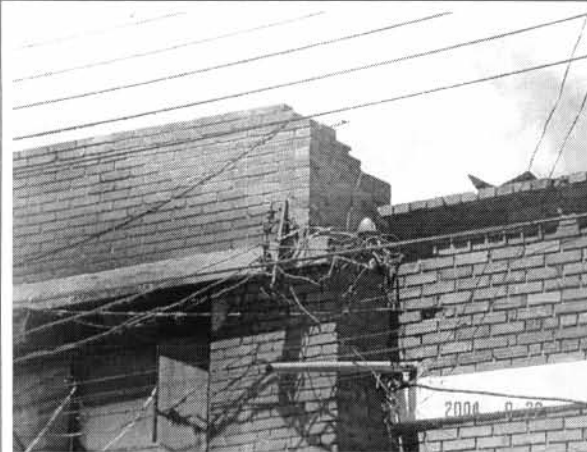
Foto 5. Aspecto externo de las reparaciones del muro.
