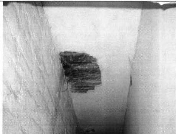
Foto 8. Cielos rasos desprendidos.
