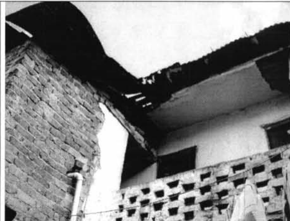
Foto 6. Cubierta con elementos sueltos
