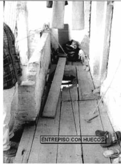
Foto 2. Entrepisos en mal estado.
