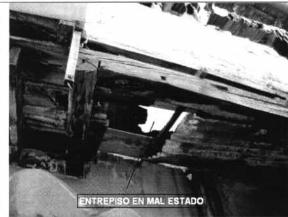
Foto 3. Entrepiso en mal estado.
