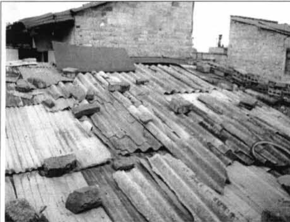
Foto 5. Cubierta con elementos sueltos
