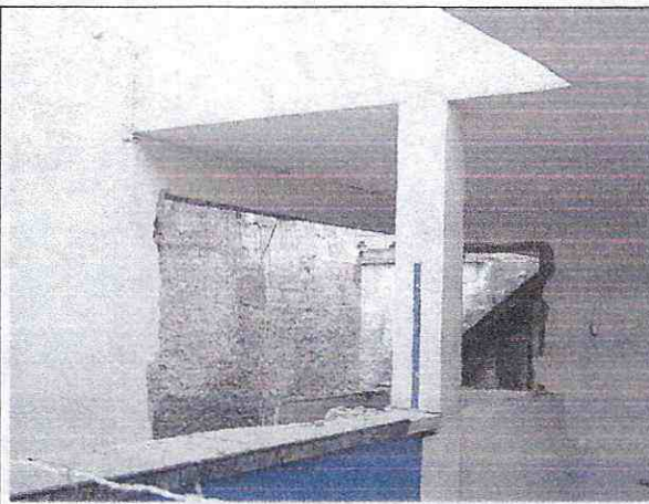
Foto 6. Inmueble abandonado y en deterioro.
