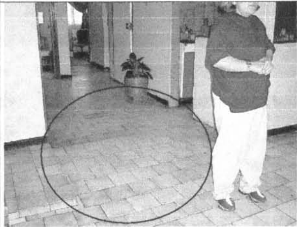
Foto 8. Desnivel en la placa de piso – Piso 3
