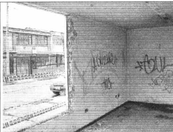
Foto 2. Deterioro interior de la edificación.
