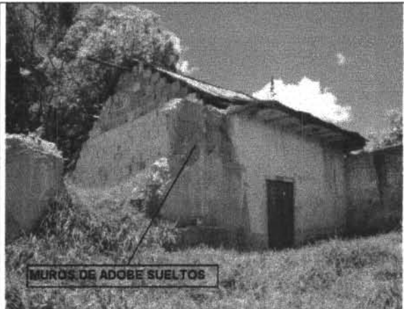
Foto 2. Fachada y muros sueltos
