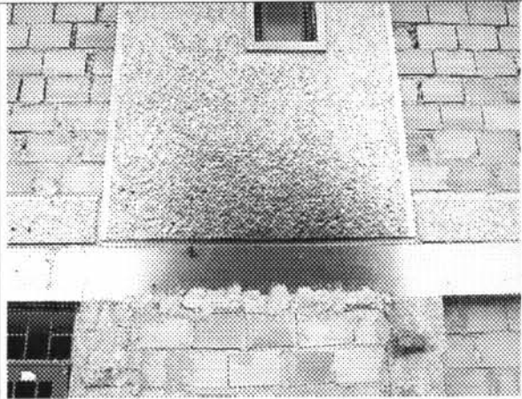
Foto 2. Muros de fachada con evidencia de incendio
