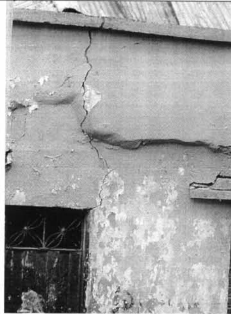
Foto 2. Muros de fachada fracturados.
