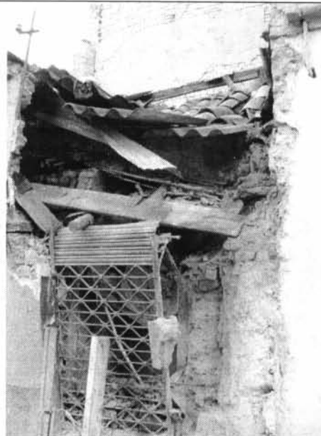
Foto 4. Fallo total de muros y cubierta.
