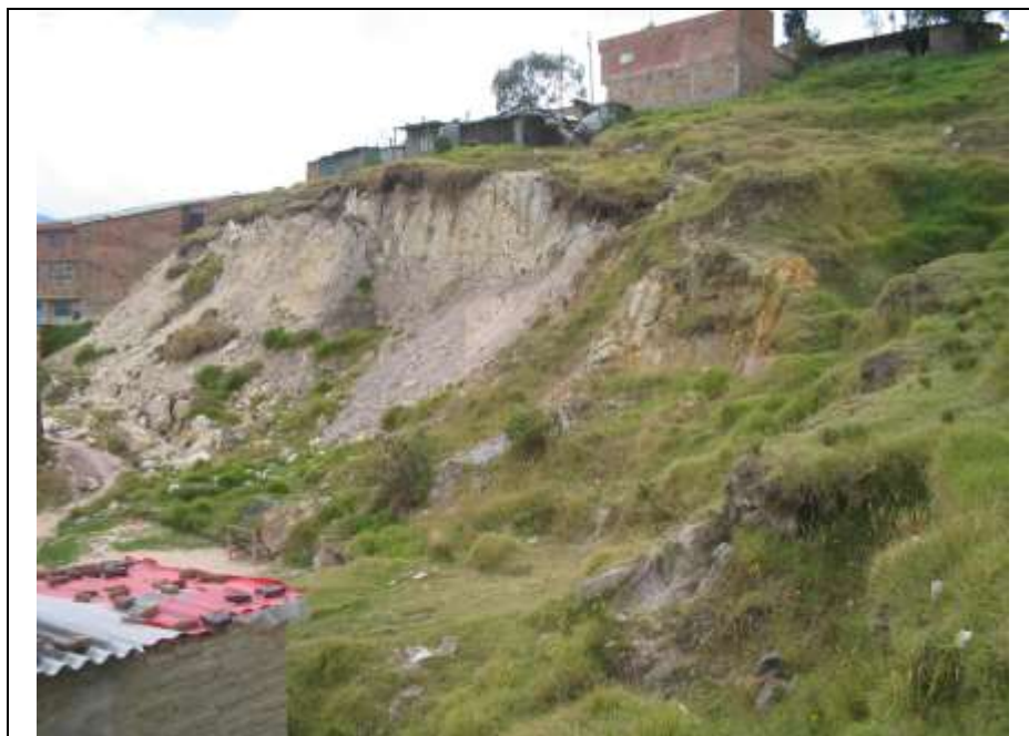
Fotografía 4. Panorámica del deslizamiento. En la parte alta aflora la capa de arenisca que conforma un talud de mayor pendiente. Hacia la parte media está el contacto con las arcillolitas, marcado por el cambio de pendiente (más suave), el cambio en la coloración y la acumulación del material deslizado y los flujos de detritos.
