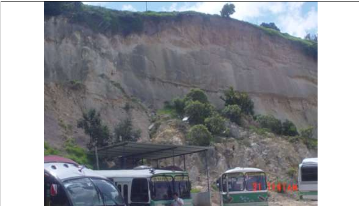
Fotografía 4-4 Bancos de arenisca con segmentos en voladizo por extracción de las arcillolitas basales que configuran la posibilidad de caída de bloques.
