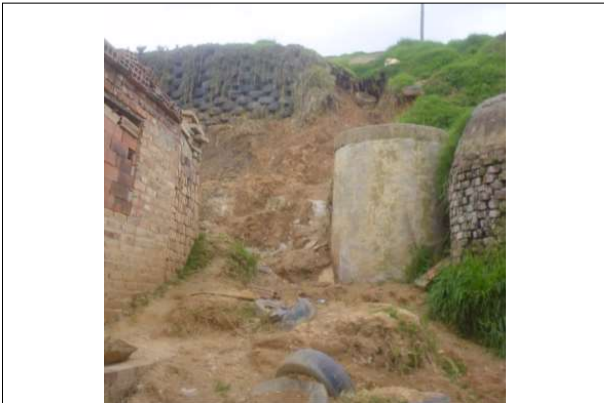
Fotografía 4-7 Flujo de lodos en la zona central, sobre el alineamiento del alcantarillado
