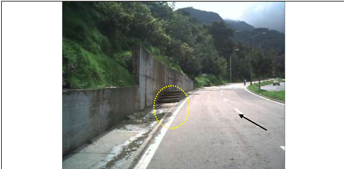
Foto 4 El círculo muestra la zona de combamiento del muro ubicado al sur del muro fallado. También se puede apreciar (indicado por la flecha) la zona en que el andén ha sido invadido por material de un flujo de tierras
