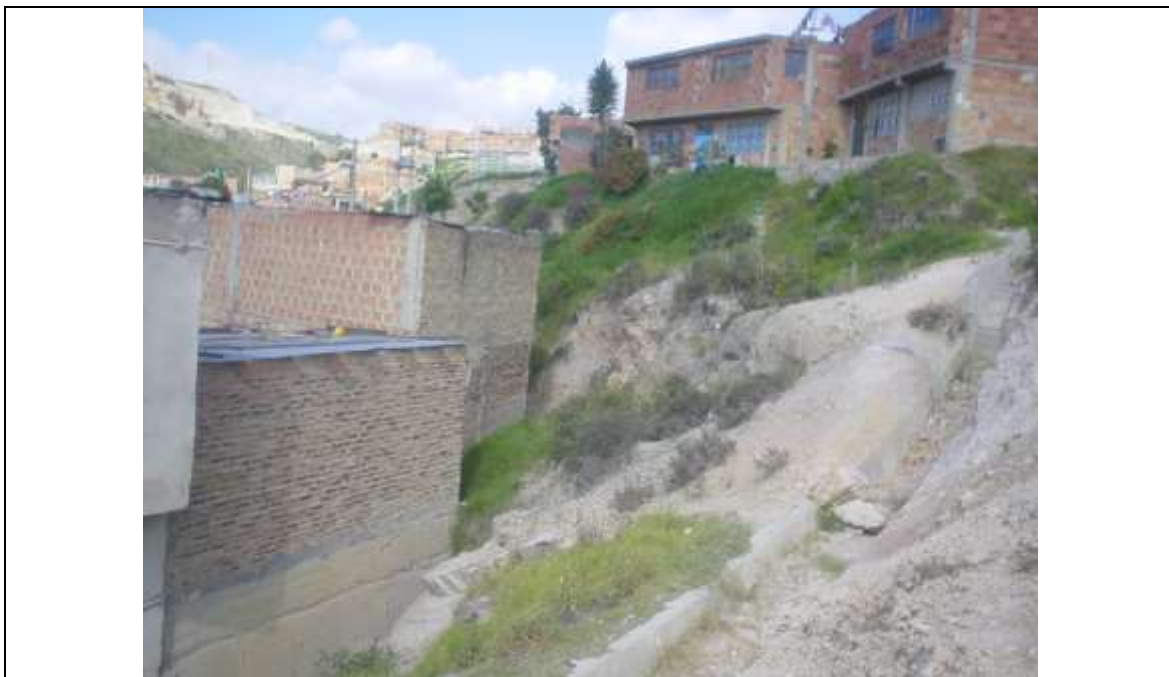
Fotografía 3-1 Colmatación de estructuras de conducción de aguas lluvias y erosión en la zona aledaña debida a las fuertes pendientes.
