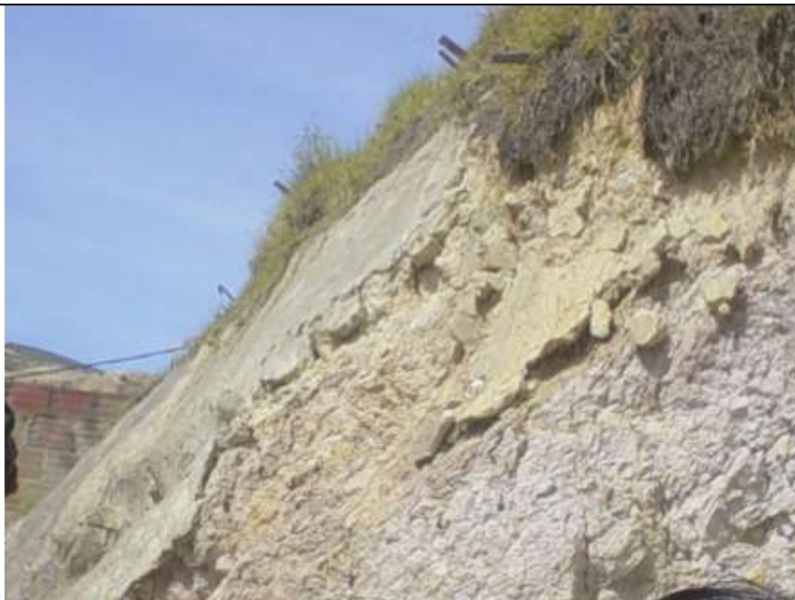
Fotografía 3-3 Desprendimiento de recubrimientos de cespedón y malla mortero.
