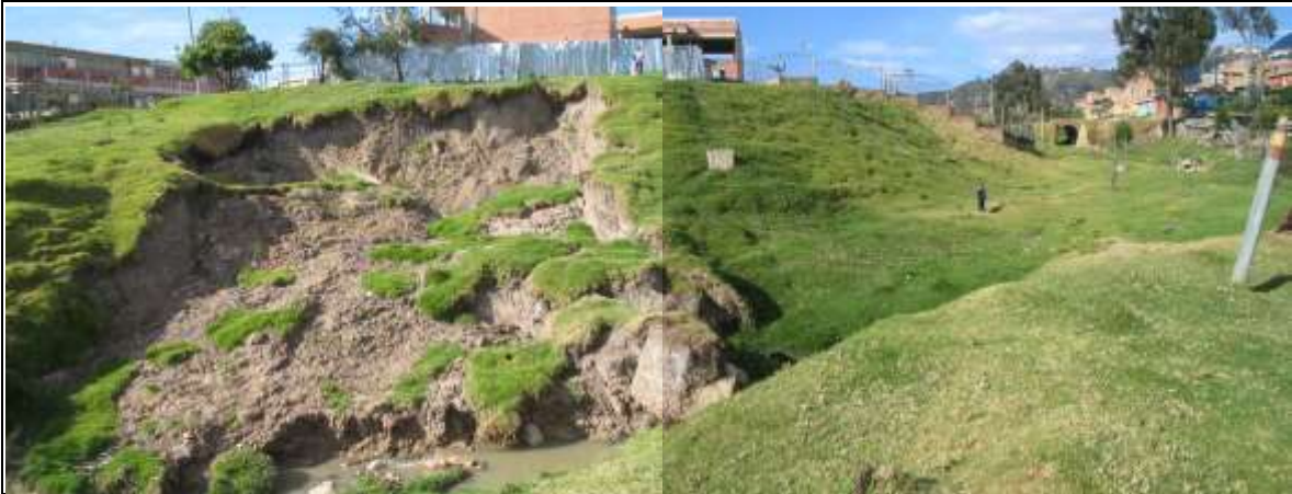
Fotografía 4-1. Aspecto general del deslizamiento. Nótense la relativa baja pendiente de la ladera afectada y la cercanía del colegio a la corona del movimiento.
