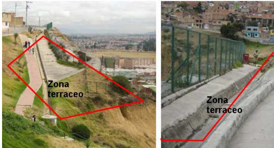
Fotografía 10.1 detalle de la afectación sendero peatonal y cuneta
