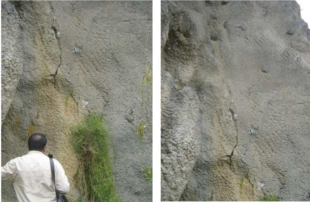
Fotografía 2.4 Grietas de tracción en le concreto lanzado existente
