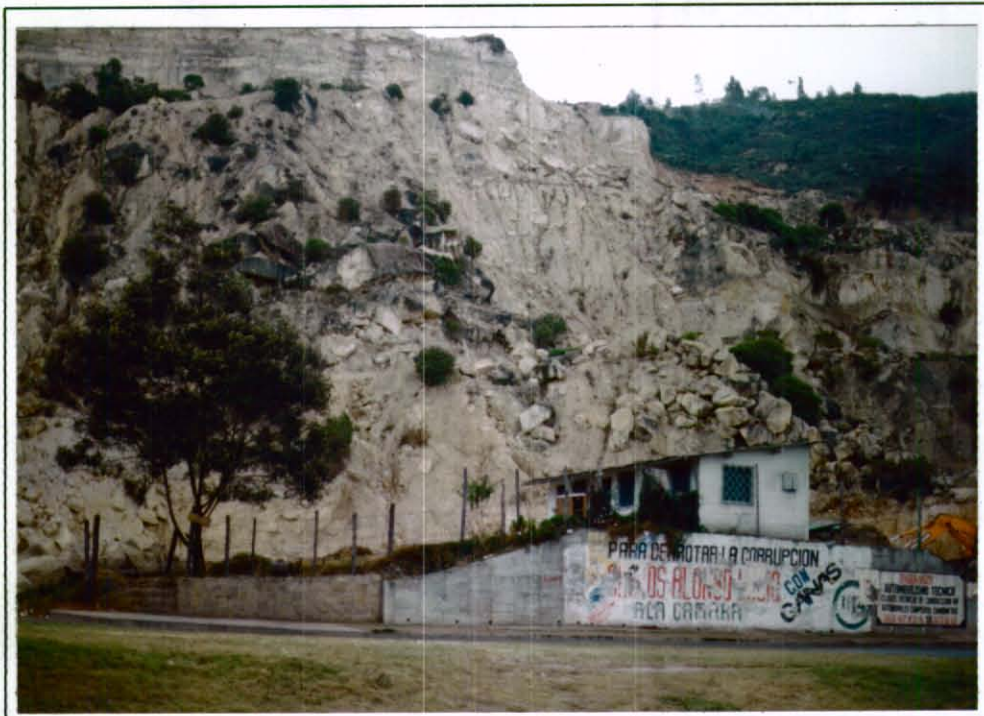
Foto 4. Cantera El Bohío, calle 162 con cra. 7ª. Nótese la amenaza que existe por caída de bloques y aporte de sedimentos para las redes de drenaje. Este problema es común en esta zona de los orientales
