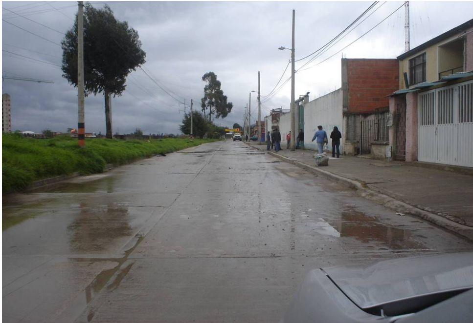
Fotografía No. 27 Carrera 9ª Calles 189 a 191. En esta zona la vía se encuentra pavimentada, pero en todo el tramo solamente se observó un solo sumidero. El agua que baja del oriente se concentra sobre esta vía, produciendo inundaciones parciales.
