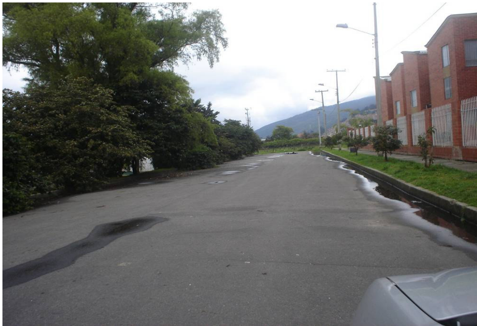
Fotografía No. 59 Calles 175 a 176 Carrera 9ª. Nótese los apozamientos de agua que deterioran el pavimento, y la falta de sumideros.
