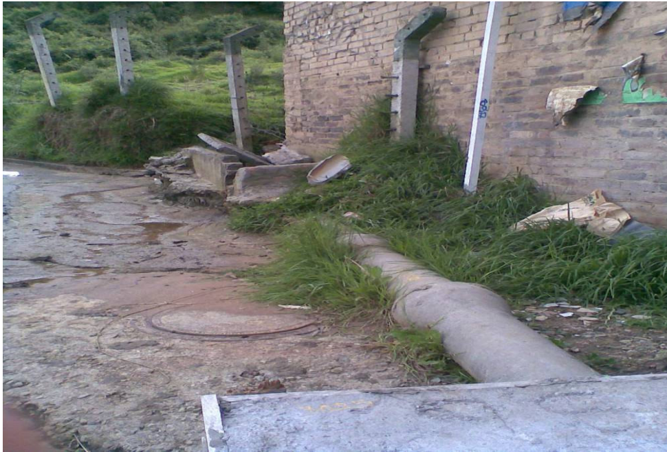
Fotografía No. 61 Calle 175 Carrera 6ª, Colegio Claustro Moderno. Las aguas bajan sin control entre el límite del lote y la pared norte del colegio. Habitantes la han canalizado artesanalmente por medio de una tubería para captación de agua para lavado de ropa.
