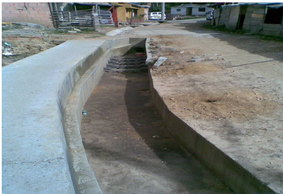
Fotografía No. 5 Calle 182 Carrera 1ª. Canal - desarenador, para recoger sedimentos producido por zonas de canteras.
