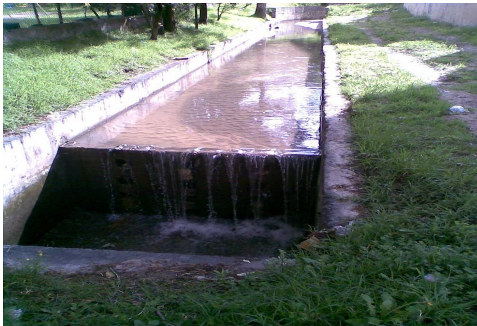
Fotografía No. 58 Calle 175 Carrera 7ª A. Canal desarenador de escorrentía que baja de ese sector visto hacia aguas arriba.
