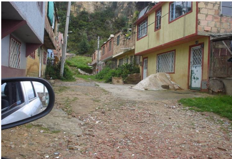
Fotografía No. 8 Carrera 1ª entre Calles 181. Vías desprovistas de pavimento, productoras de sedimentos.
