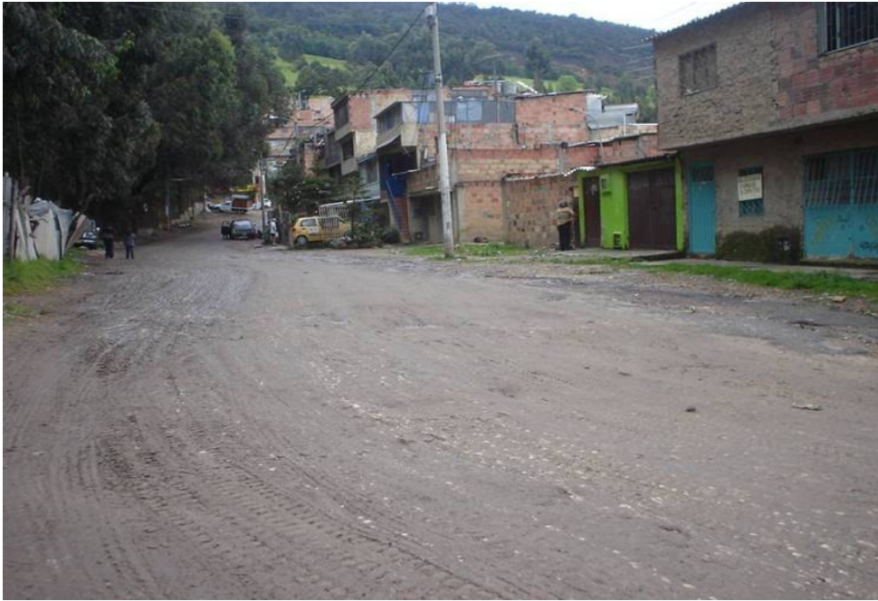
Fotografía No. 13 Calle 192 entre Cr. 2ª a Cr. 4ª. La vía se encuentra deteriorada, no existen cunetas construidas, parcialmente se encuentra deteriorado el pavimento, produciéndose un alto transporte de sedimentos.
