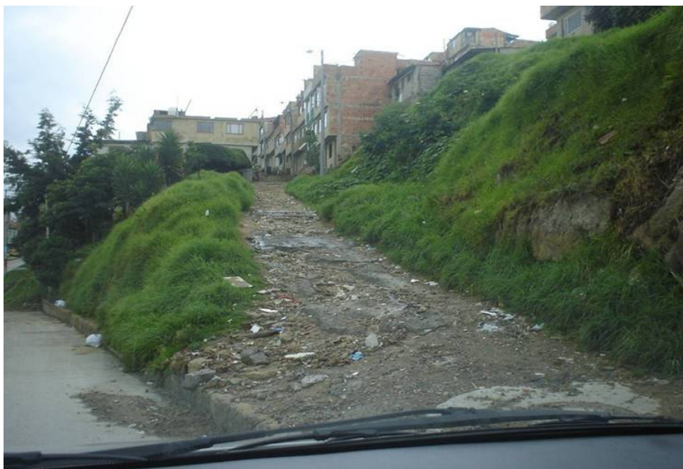
Fotografía No. 15 Carrera 5ª entre calles 185 a 189. Vía totalmente destapada, productora de escorrentía y sedimentos. (Calle 189)
