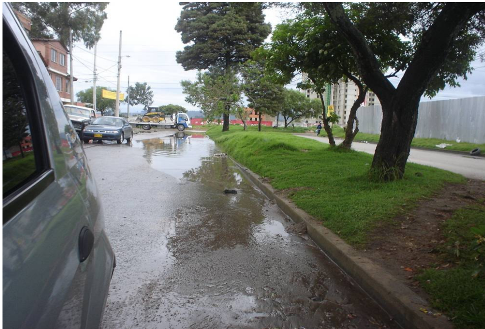
Fotografía No. 26 Carrera 7ª Calle 191. Apozamientos de agua por mala nivelación del pavimento, lo cual lo deteriora.
