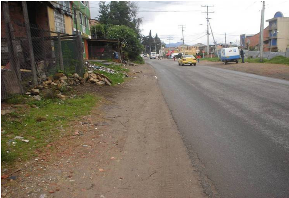
Fotografía No. 21 La vía no posee cunetas o sumideros que recolecten las aguas ni los sedimentos aferentes a la vía.
