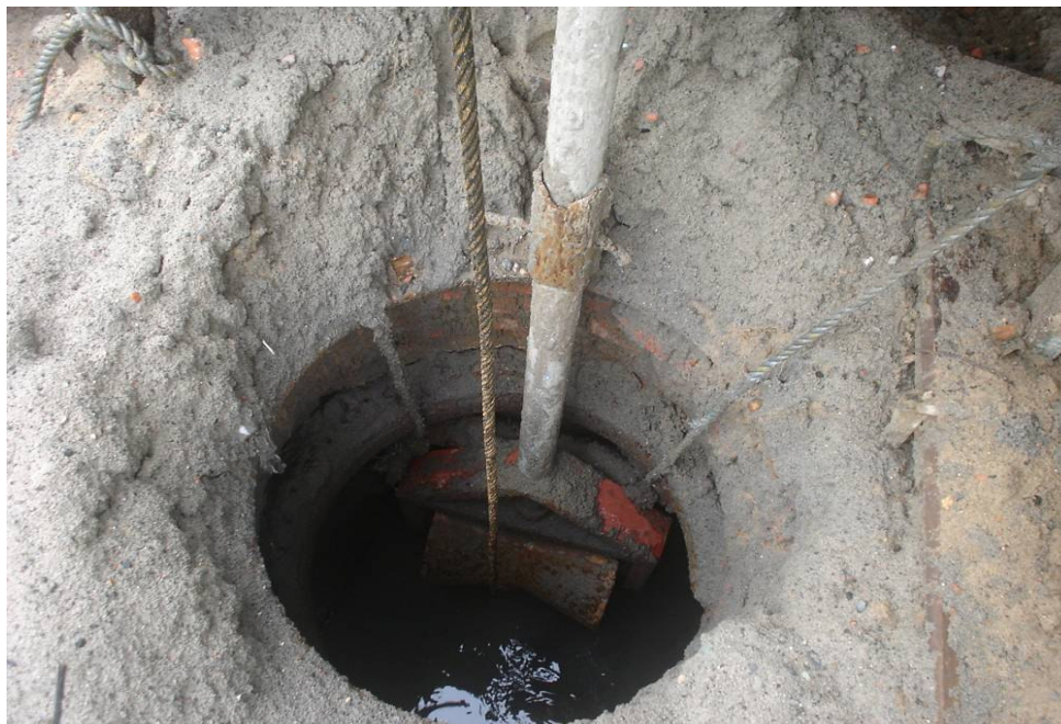
Fotografía No. 44 Calle 182 Carrera 9ª. Pozo de donde se extraen arenas del alcantarillado pluvial por parte de la EAAB.
