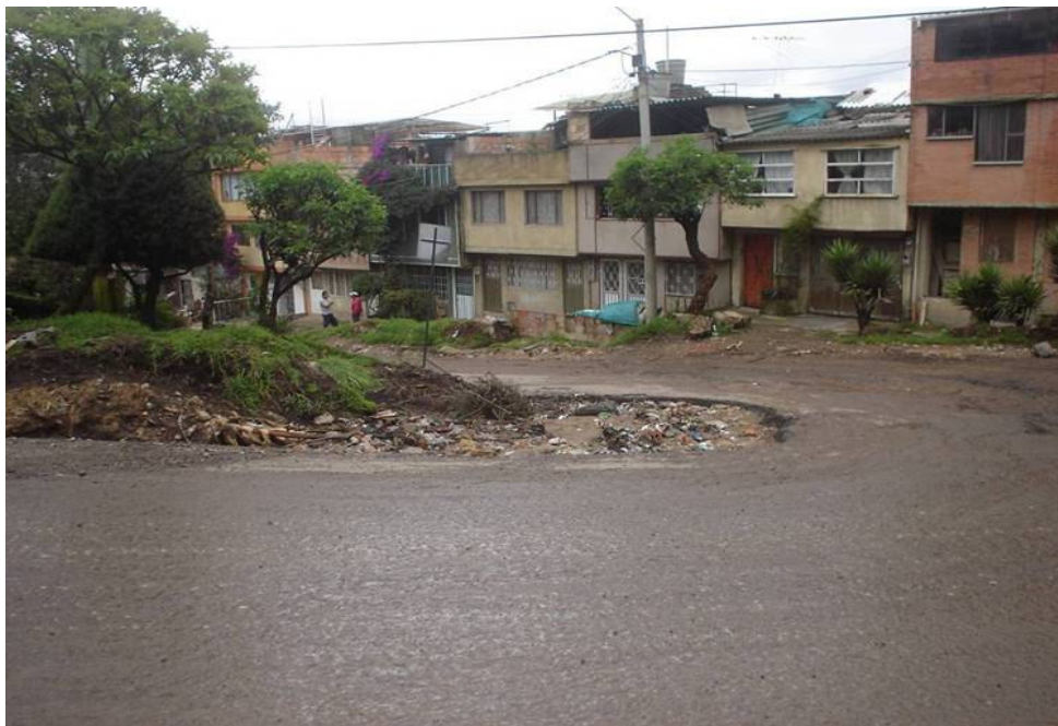
Fotografía No. 12 Calle 192 con Cr. 2ª. La vía se encuentra deteriorada, no existen cunetas construidas, parcialmente se encuentra deteriorado el pavimento, produciéndose un alto transporte de sedimentos.
