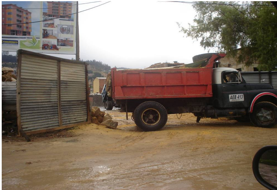
Fotografía No. 39 Carrera 9ª Calles 183 a 182. Depósitos de materiales para construcción. Debido a lluvias o a mal manejo de éstos. los sedimentos salen a las vías.
