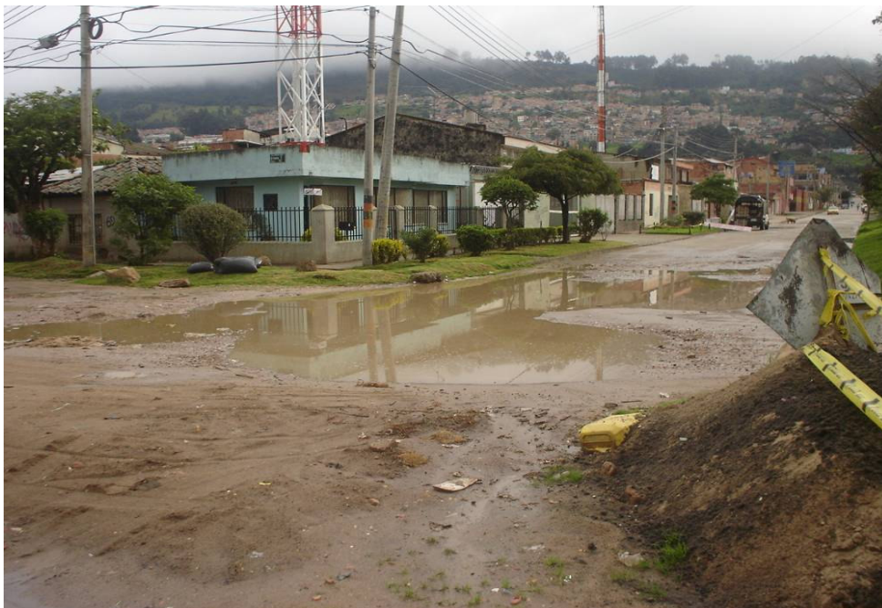
Fotografía No. 42 Vista de la Calle 182 hacia los cerros Orientales, desde la Carrera 9ª. Nótese los apozamientos de agua por falta de un drenaje adecuado y por colmatación de tuberías.
