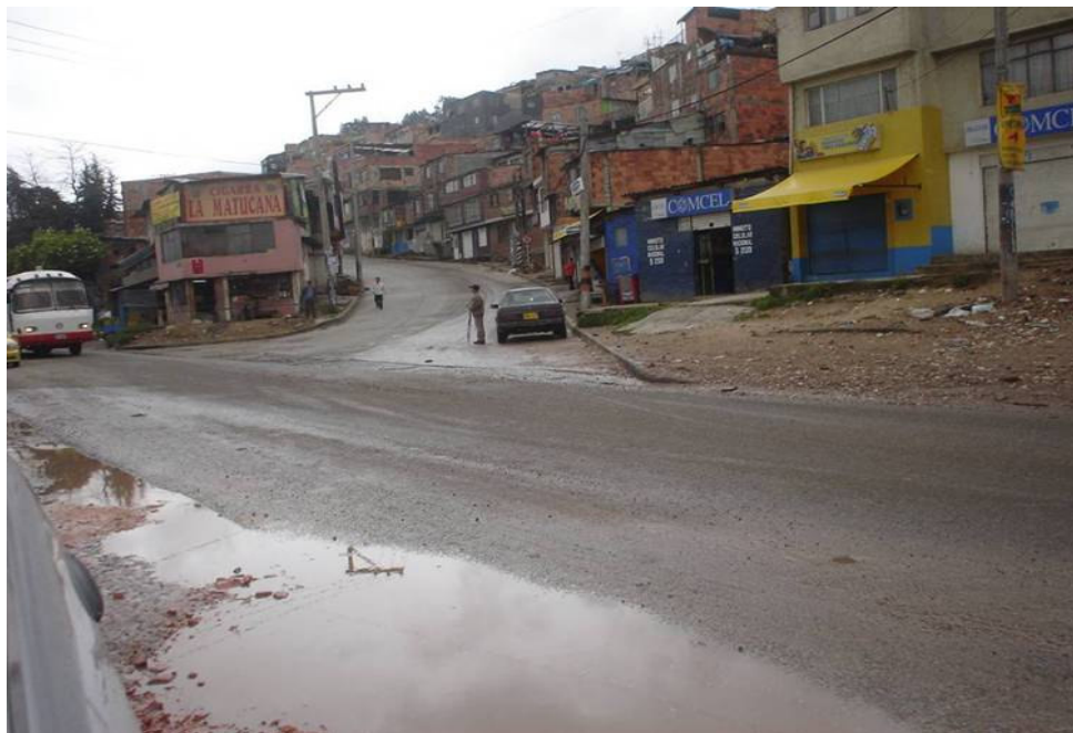
Fotografía No. 20 La vía no posee cunetas o sumideros que recolecten las aguas ni los sedimentos aferentes a la vía. También se nota agua con sedimentos apozada en el costado occidental de la Carrera 7ª.
