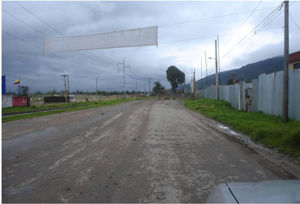
Fotografía No. 25 Carrera 9ª Calles 191 a 193. En esta área el pavimento se encuentra muy deteriorado. Existen pozos en donde se acumula el agua, no existen sumideros, y el drenaje es muy deficiente.
