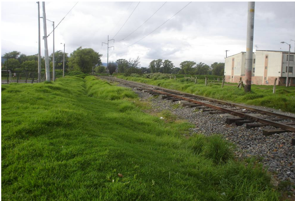
Fotografía No. 48 Calle 181 Carrera 9ª. Vía del ferrocarril, la cual opera como un dique. Debido a lo anterior, en algunas zonas se producen inundaciones cuando el alcantarillado es insuficiente.
