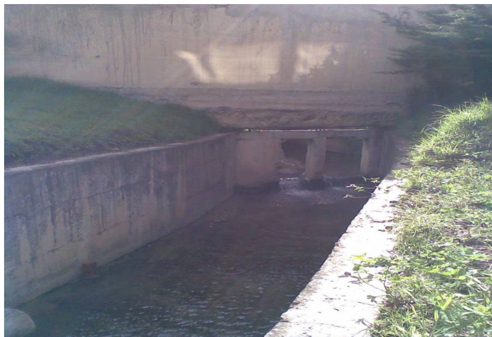
Fotografía No. 56 Calle 175 Carrera 7ª A. Vista hacia aguas arriba del canal desarenador de escorrentía que baja de ese sector.
