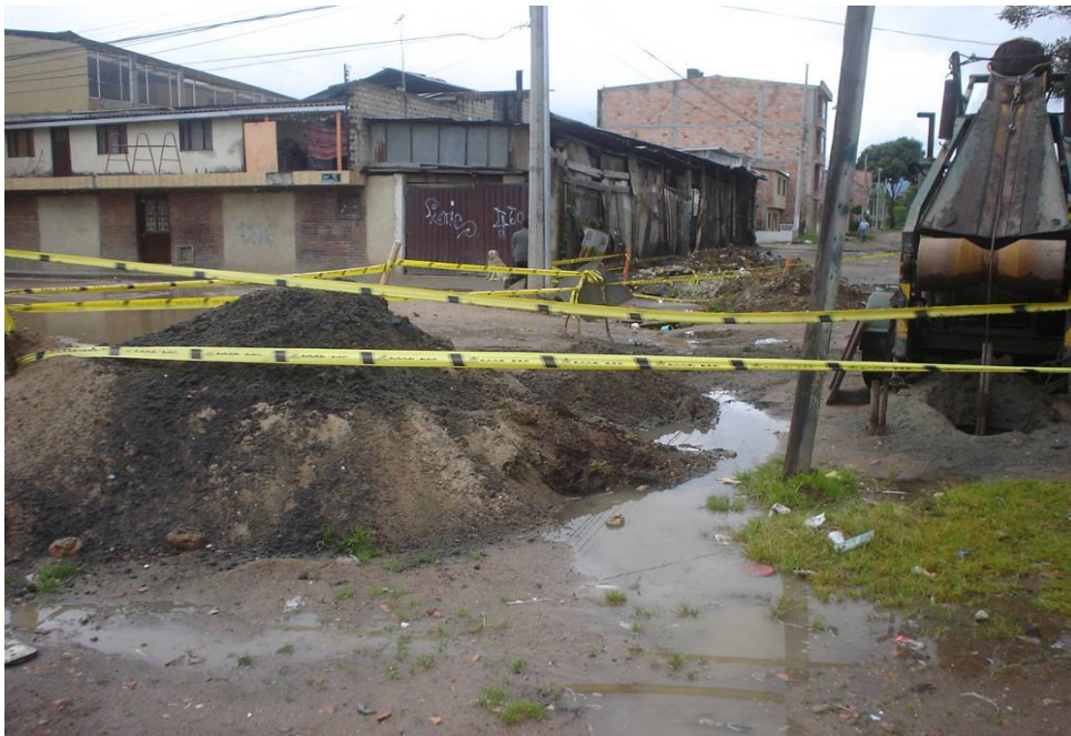
Fotografía No. 45 Calle 182 Carrera 9ª. Depósitos de arenas extraídas de las tuberías del alcantarillado, que bajan desde la parte alta de la zona.
