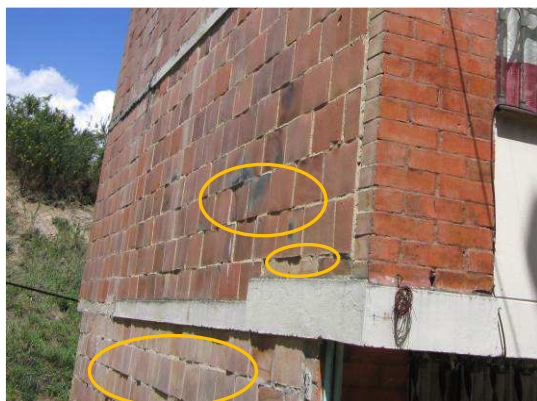
FOTO 7.3 IRREGULARIDADES EN LOS MUROS: ELEMENTOS CERÁMICOS SOBRESALEN DEL CONJUNTO
