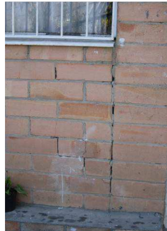
FOTO 7.2 PEGAS DE LA MAMPOSTERÍA DE DEFICIENTE CALIDAD
