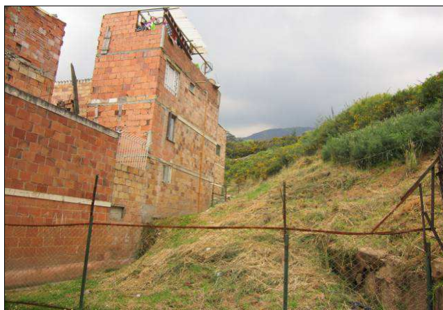
FOTO 1.2 PERSPECTIVA DE LAS EVIDENCIAS DEL DESLIZAMIENTO EN EL BORDE SUR DE LA SEGUNDA ETAPA
