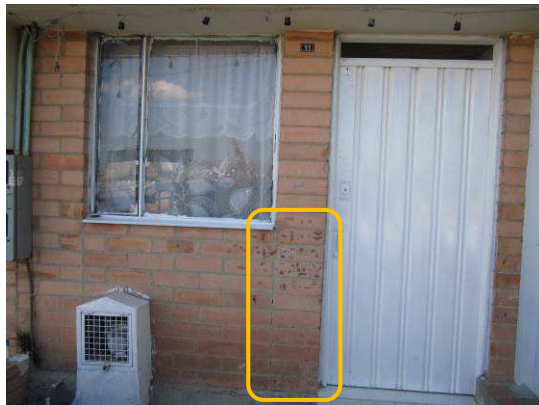
FOTO 7.1 ELEMENTOS DE LOS MUROS DE FACHADA SIN SUJECIÓN O TRASLAPO
