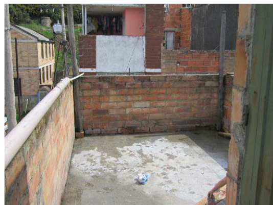
FOTO 7.4 MUROS DEL ÚLTIMO NIVEL SIN CINTA DE REMATE
