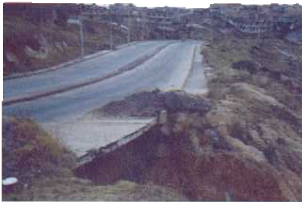
Barrio Arborizadora Alta. Localidad Ciudad Bolívar. Erosión en cárcavas que afecta el talud superior de la vía principal.
