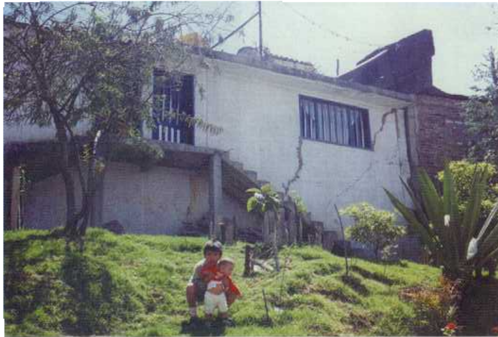
Barrio Bogotá Sur. : Localidad Ciudad Bolívar. : Vivienda con grietas en : las ventanas y desplazamiento : de las columnas. : .....
