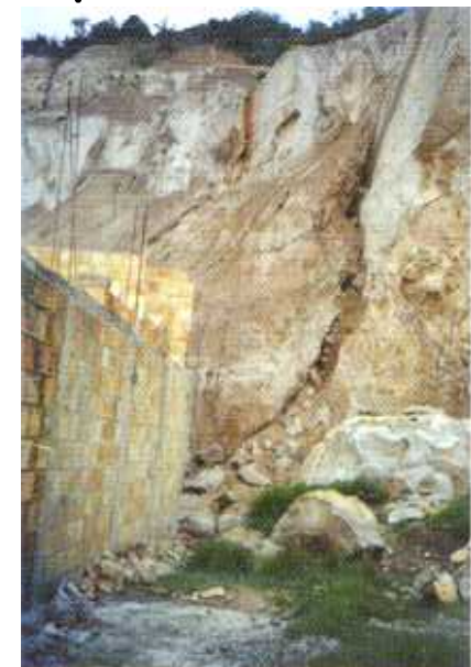
Barrio La Fiscala. Localidad Usme. Desprendimiento de rocas y material suelto ocasionado por la presencia de agua en las grietas.
