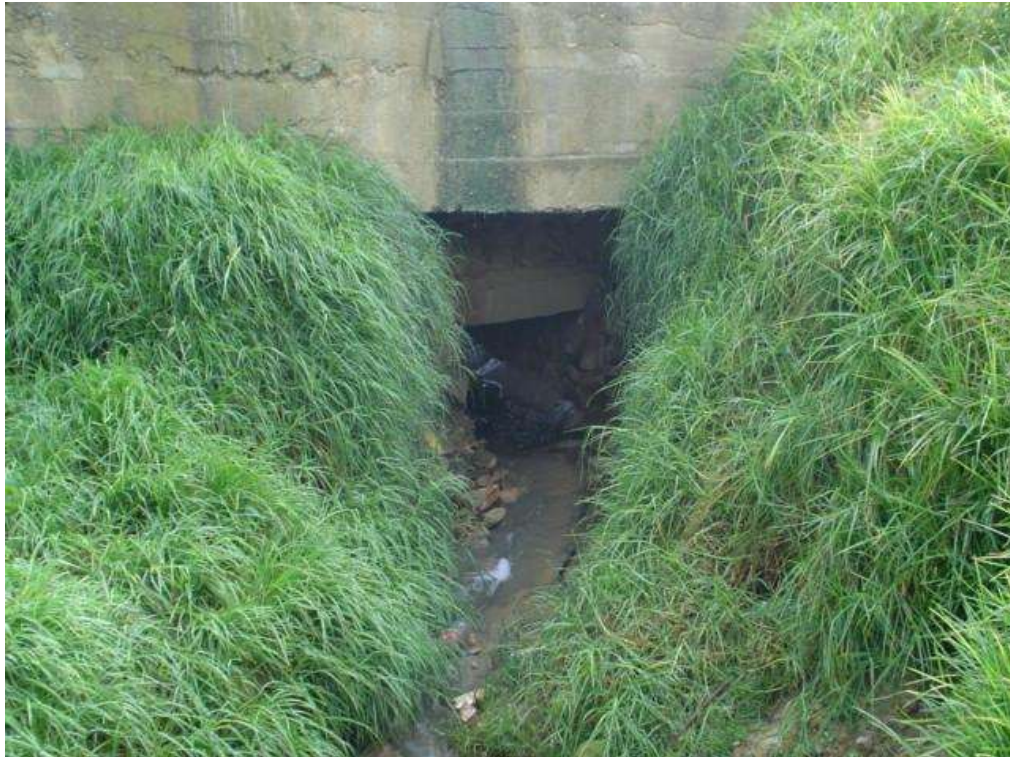
Fotografía 24. Detalle e la entrada a la estructura de conducción, bajo la vía.
