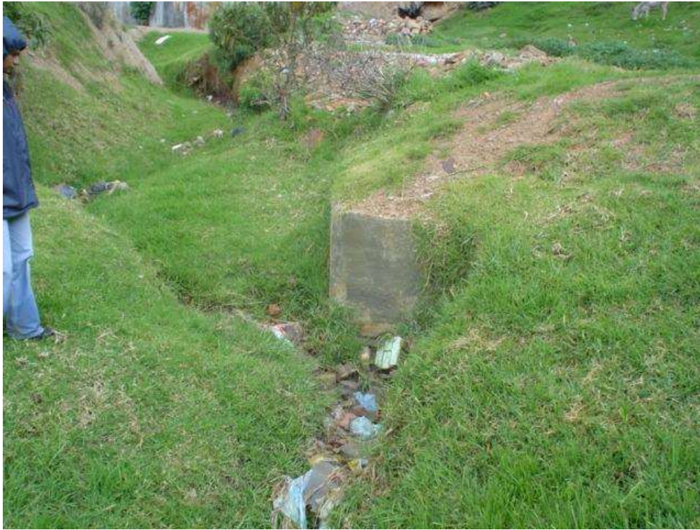
Fotografía 13. Cauce de la quebrada por el borde del patio de la antigua explotación.
