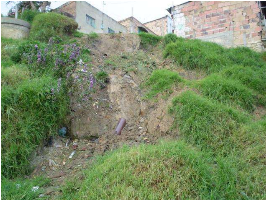
Fotografía 28. Desprendimientos de material de la margen izquierda; se aprecian fragmentos del antiguo alcantarillado.
