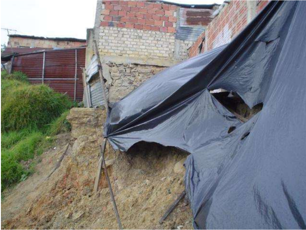
Fotografía 34. Sector donde hubo una casa que fue afectada por el proceso de inestabilidad.
