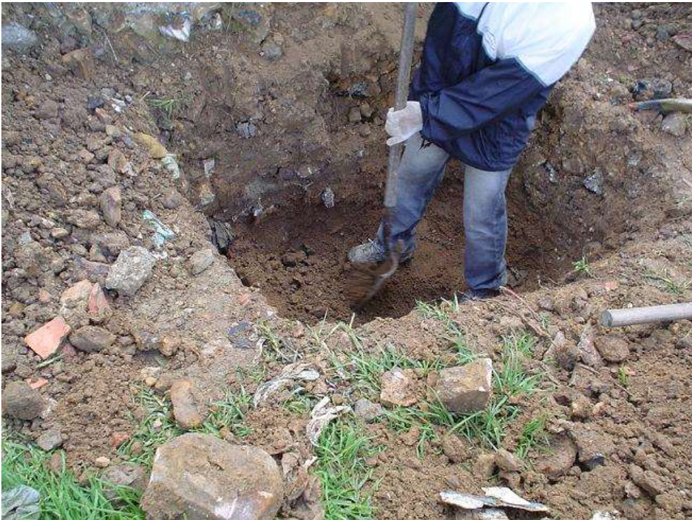
Fotografía 12. Excavación de un apique en la base del talud, se aprecian escombros y basuras.
