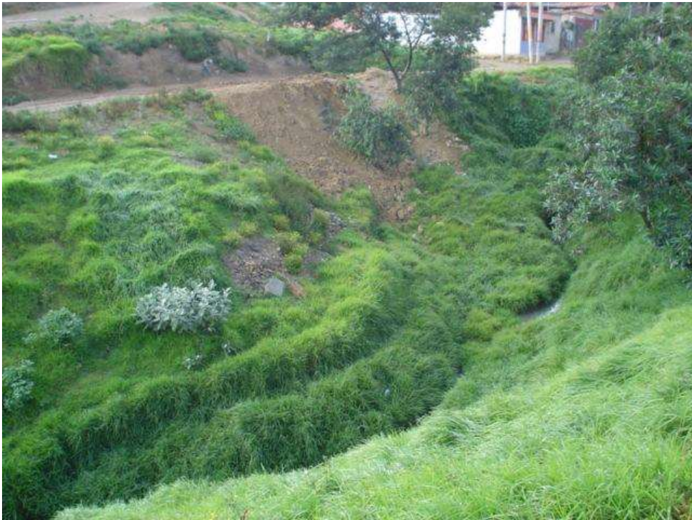
Fotografía 21. Margen izquierda de la quebrada, se aprecian materiales botados por la ladera y la huella en el pasto de una creciente reciente.
