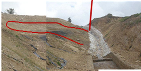
Afectación por proceso en K0+600 sobre canal de la quebrada Santo Domingo
