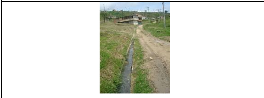
Cunetas colmatadas a lo largo de la diagonal 75B sur
