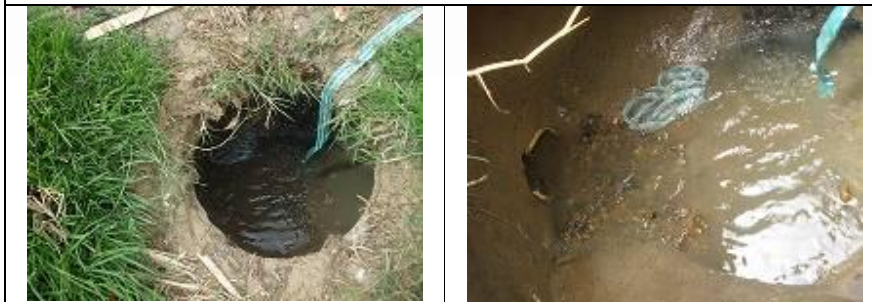
Pozo sin tapa sobre la diagonal 75B sur (barrio Santa Viviana)
