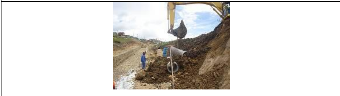
Obra para encausar aguas lluvias a canal de la quebrada Santa Rita
