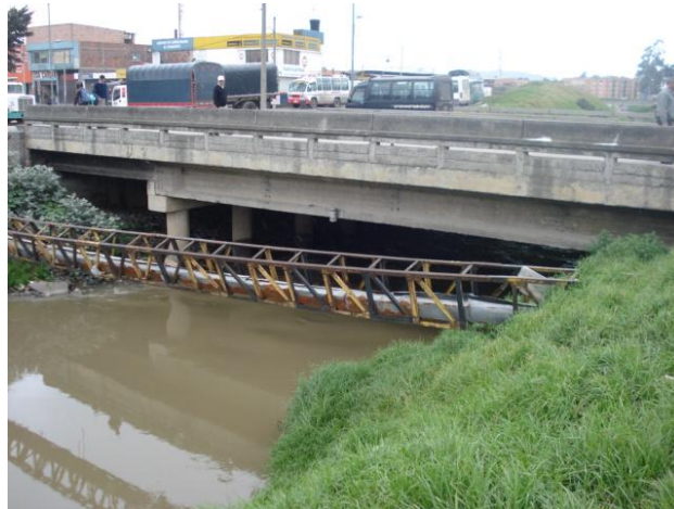
Foto 7. Puente de la carrera 86 Av Agoberto Mejía, lugar de instalación del sensor Kennedy
