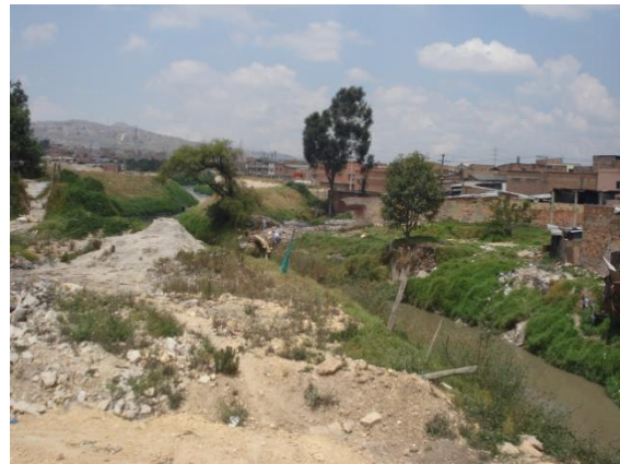
Foto 6. Vista del jarillón del río Tunjuelo en la confluencia con la Qda. Chiguaza.
